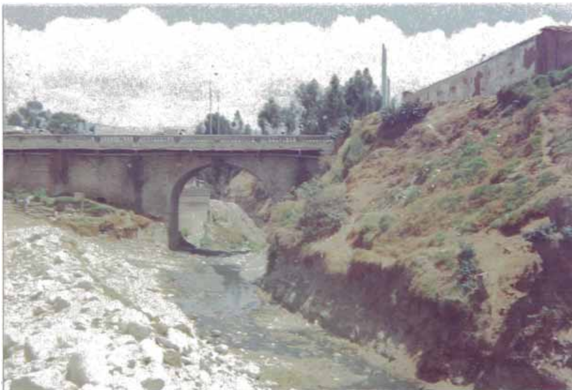
FOTO N o 2.4: Puente Centenario, fue uno que impidió el paso del Aluvión en forma parcial, se estima que el caudal llegó a cubrir la altura del puente ( H = 4m )
