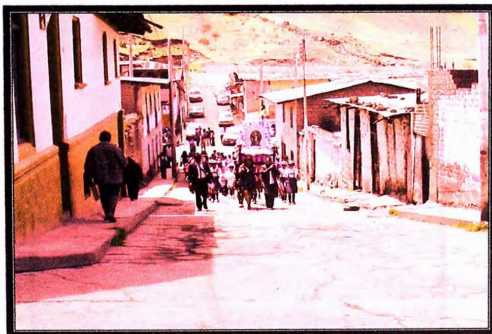
Fotografía Nº 6.3 Centro poblado de Canta. Se muestra una de sus vías internas, Jr. Tacna, con el pavimento completamente agrietado.
