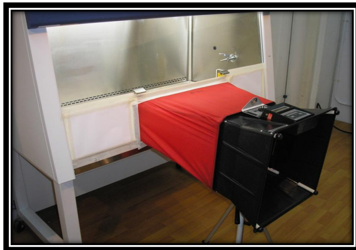
Fig. 14 Colocación del balómetro
