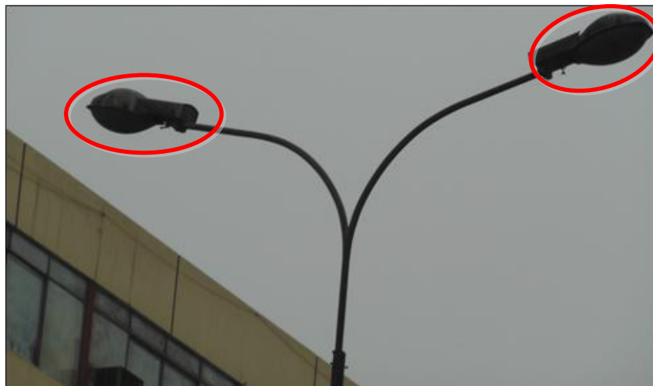
Fotografía 5. Vista de artefacto de alumbrado público cuya superficie del difusor está cubierta de Material Particulado en la Avenida Abancay
