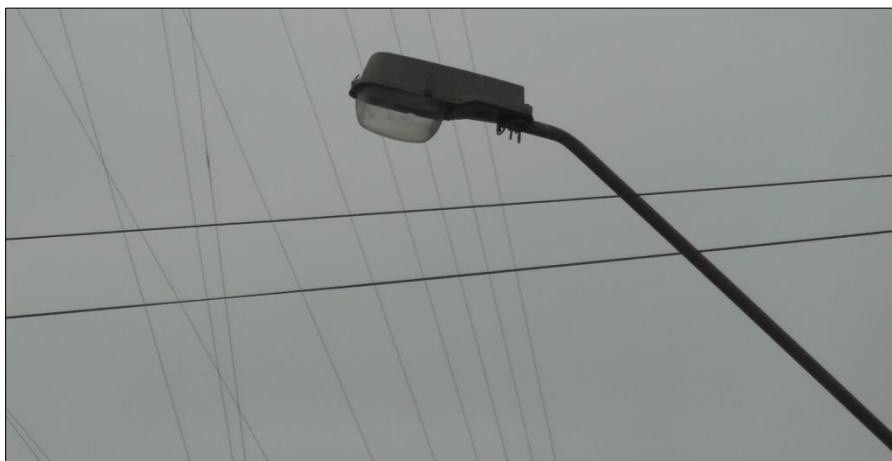
Fotografía 6. Vista de alumbrado público con difusor limpio
