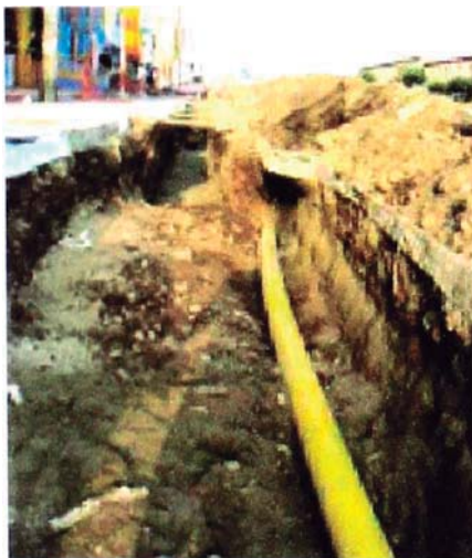
Foto 28. Sobre excavación debido a colectores colapsados.
