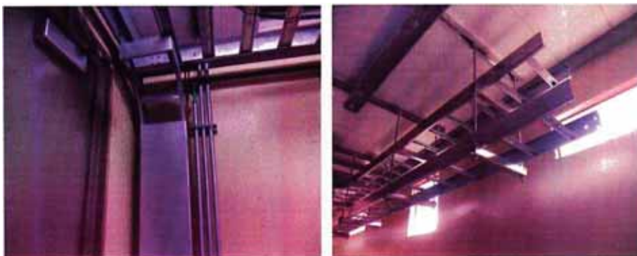
Fig. 4.32 Bandejas porta cables instalados
