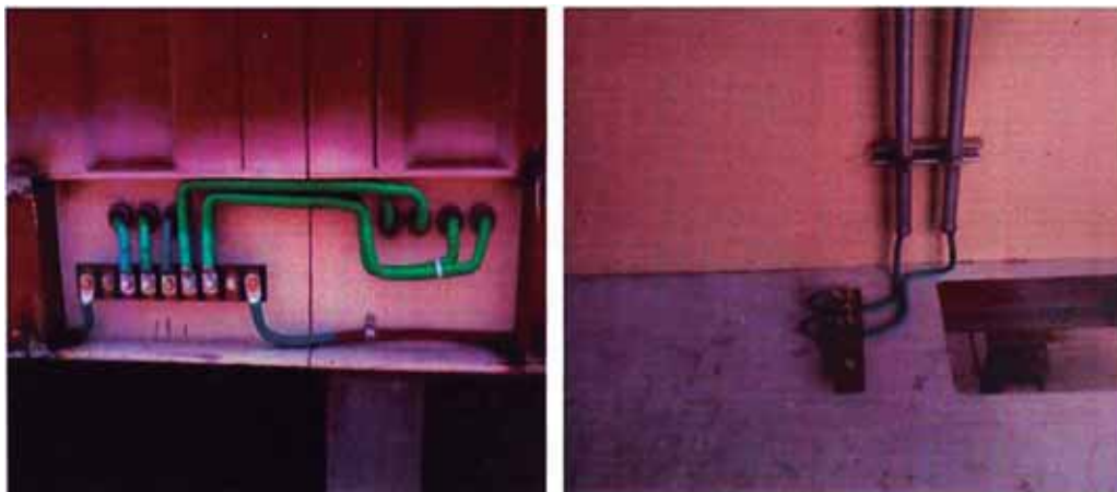
Fig. 4.45 Cables de tierra
