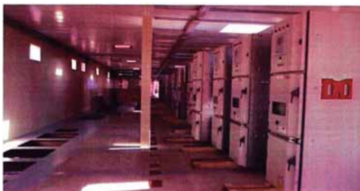
Fig. 4.40 Ubicación de equipos
