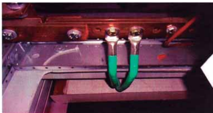
Fig. 4.43 Cable a tierra en equipo de fuerza
