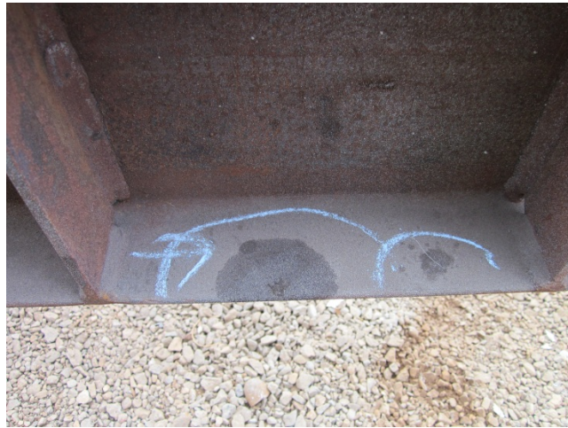
Figura 5. Elemento que presenta manchas de grasa
