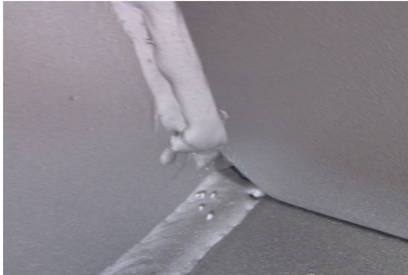
Figura 11. Restos de escoria en cordon de soldadura.
