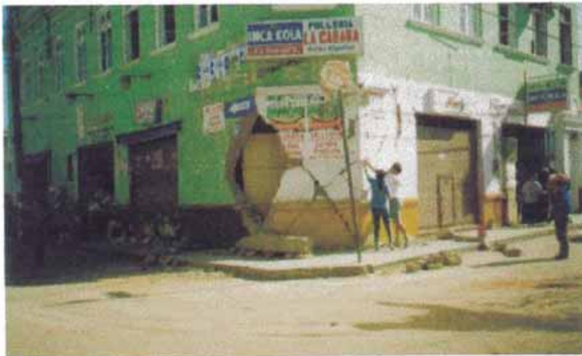
Figura 1.2 Daño producido en la esquina débil de un edificio en el sismo que sacudió la ciudad de Nazca en noviembre de 1996.
