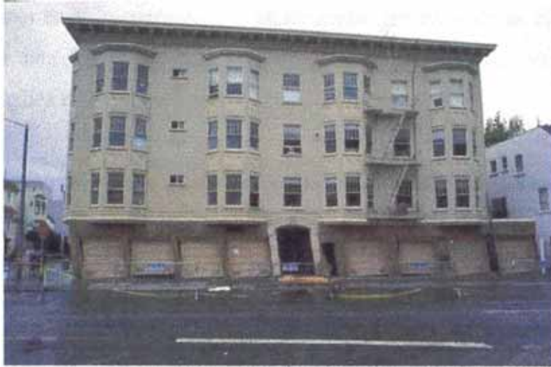
Figura 2.1 Daño sísmico en una configuración con el piso blando en el primer nivel. Las grandes aberturas generan grandes distorsiones en ese piso.
