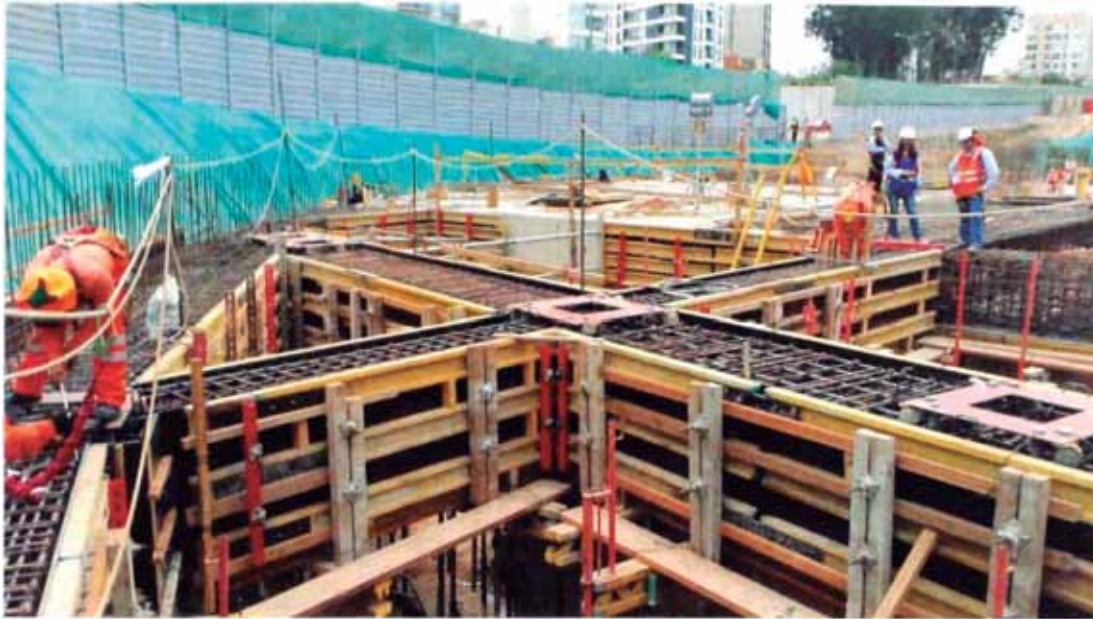
Figura N°33.- Plantillas de aisladores instaladas en pedestales
