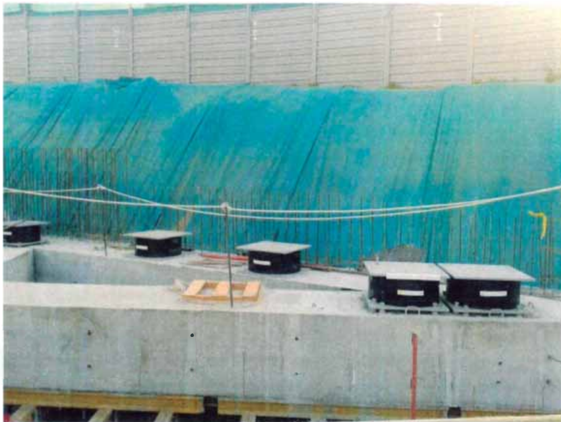
Figura N°43.- Aisladores sísmicos instalados
