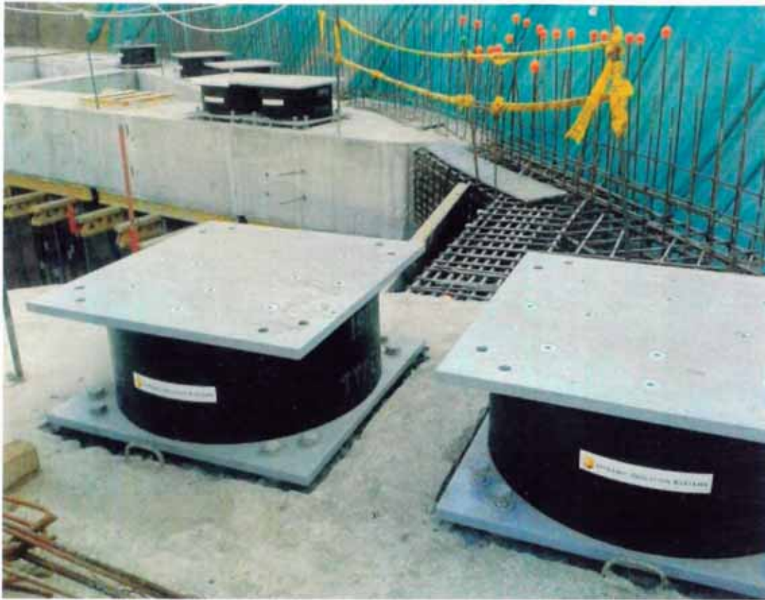
Figura N°44.- Vista de aisladores instalados
