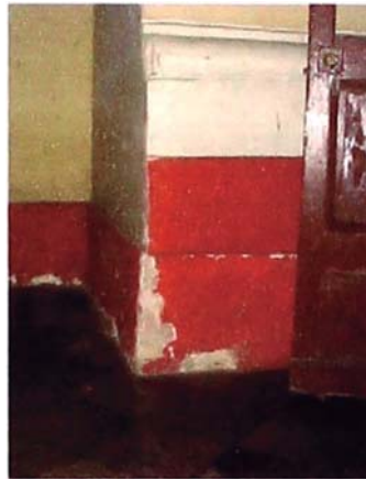
Foto 5.9. Humedad en la parte baja de contrafuertes al interior de las capillas. Ejes 4 y B. Nótese descascaramiento de pintura.
