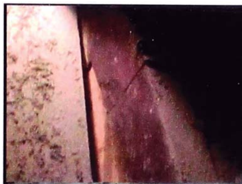
Foto A.24. Vista interior – Elementos de madera que conforman los arcos de madera. Obsérvese unión entre elementos que definen la forma como están contruidos.
