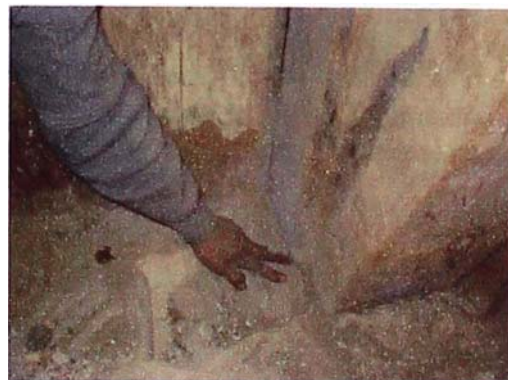
Foto 5.5. Levantamiento de columna de madera en un pilar, debido a la inclinación del mismo.
