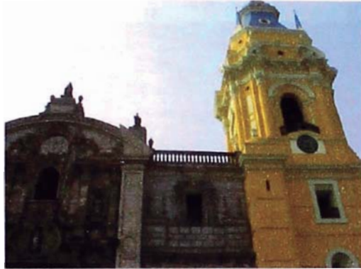
Foto A.40. Vista exterior de torre de la catedral del lado de la puerta de los Judíos.
