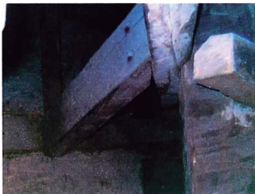
Foto 5.29. Al centro se observa conector uniendo elemento vertical y diagonal al fondo. Entre ejes 3 y D.
