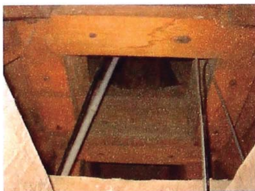
Foto A.7. Vista interior – elementos horizontales de madera de cerramiento del pilar en la parte superior de este.
