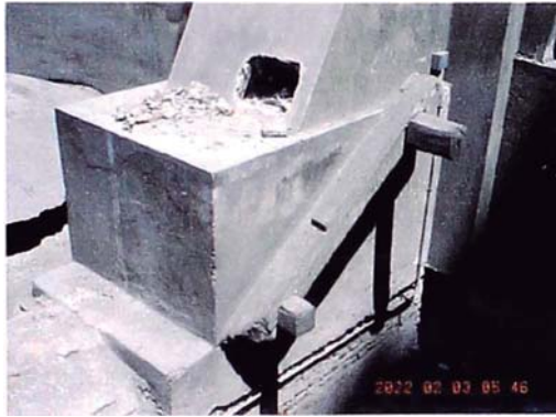
Foto A.64. Véase elementos huecos que contienen elementos de madera inclinados que van desde la estructura del techo hacia los muros contrafuertes.
