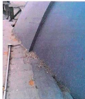
Foto 5.35. Fisuras leves y resanes en la cobertura de la cúpula posterior.
