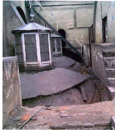
Foto 5.13. Deterioro de bóvedas sobre capillas de lado de la Puerta de los Naranjos. Pérdida de la capa exterior de mortero de concreto.
