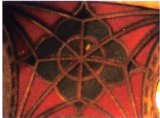
Foto A.49. Vista interior de bóvedas de las torres por debajo del nivel de los campanarios.
