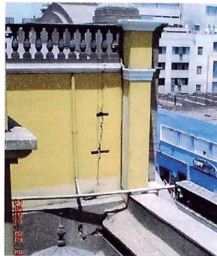
Foto 5.7. Agrietamiento en contrafuerte del eje 5. Obsérvese, refuerzo con grapas de acero.
