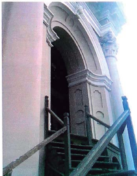
Foto 5.38. Fisura en zona superior portal de la torre ubicada del lado de la Puerta de los Judíos.
