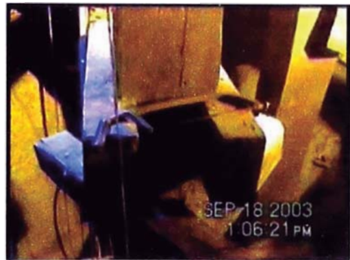
Foto A.22. Vista interior – Puntales principales verticales que soportan el techo plano y que se apoyan sobre los pilares de madera.
