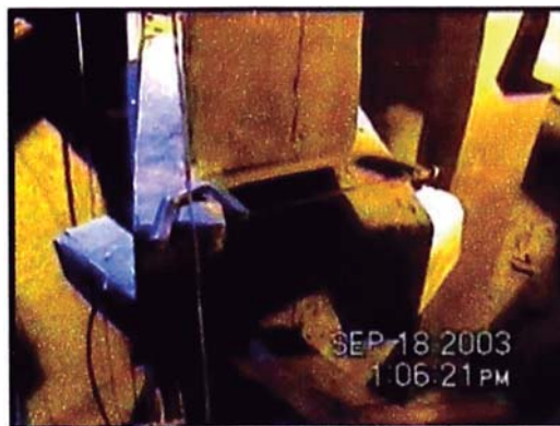
Foto 5.31. Entre los ejes 6 y C, conectores de madera que no llegan a los elementos de soporte diagonal.
