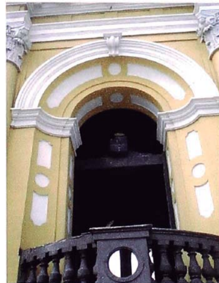
Foto 5.39. Fisuras en la zona superior del portal en torre ubicada del lado de la Puerta de los Naranjos.
