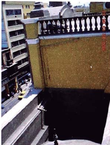
Foto 5.6. Agrietamiento en muro contrafuerte del eje 6.
