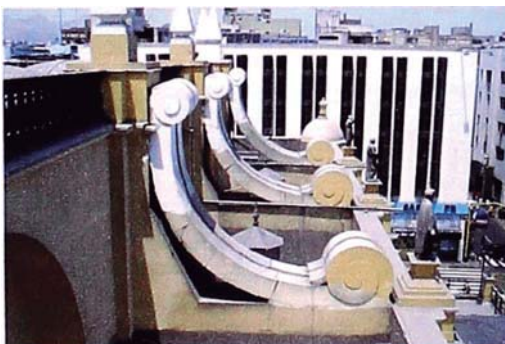
Foto 5.42. Fisuras en elementos decorativos del lado de la Puerta de los Judíos.
