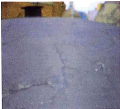
Foto 5.22. Grietas en la cobertura exterior de las bóvedas nervadas de madera.
