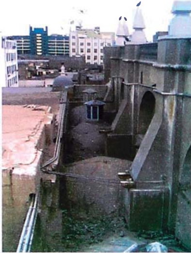
Foto 5.12. Deterioro de las bóvedas sobre capillas del lado de la Puerta de los Naranjos. Obsérvese eliminación de muros contrafuertes por sobre las bóvedas.
