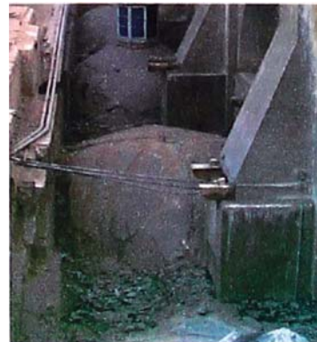
Foto 5.11. Contrafuerte faltante por encima de bóvedas laterales, del lado de la Puerta de los Naranjos, hacia la Puerta de Santa Apolonia. Obsérvense restos de mampostería
