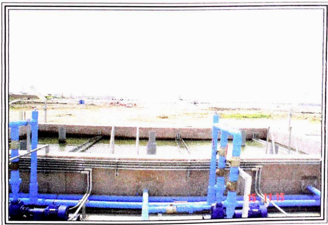
Foto 02 Estanque decantador con recirculación de lodos- Aeropuerto Jorge Chavez
