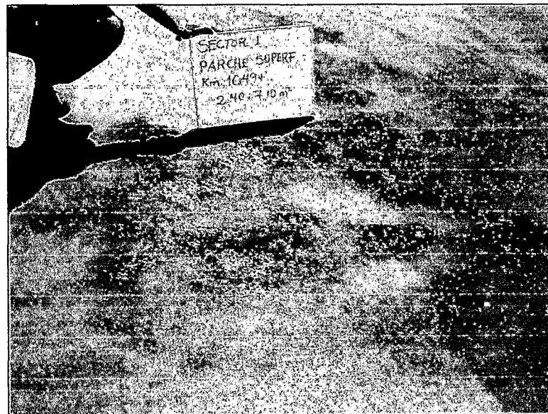
Foto AN3-4 La necesidad de realizar un parche en el km 1049+00 de 2.40 x 7.10
