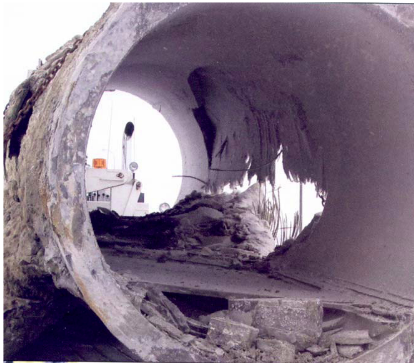
FIGURA 24. ROTURA DE TUBERÍAS DE GRAN DIÁMETRO HORMIGÓN ARMADO Y PRETENSADO(RAJANI, 2009A).
