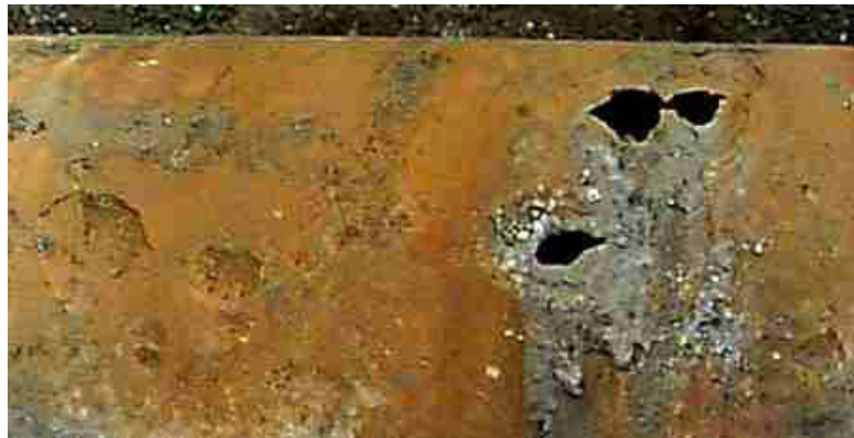
FIGURA 18. EJEMPLO DE CORROSIÓN EN TUBERÍA DE HIERRO DÚCTIL.
