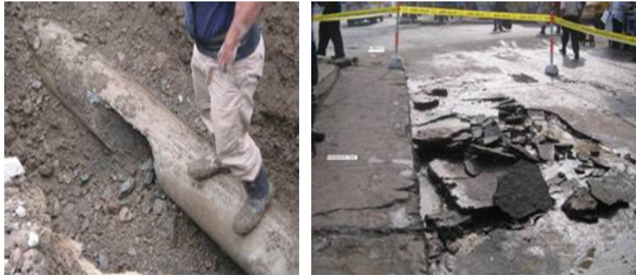
FIGURA 59. COLAPSO DE TUBERÍA DE AGUA POTABLE AC D=6" EN ZONA EJECUTADA POR TERCEROS
