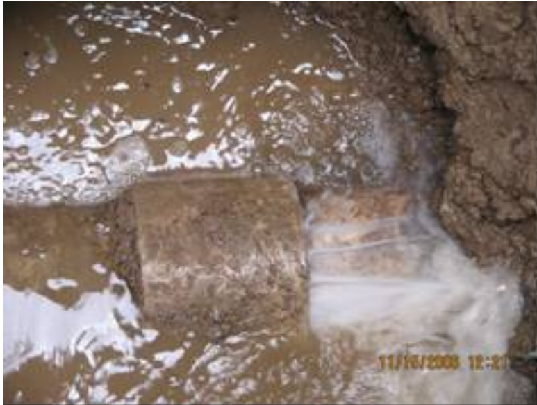
FIGURA 58. FUGA EN UNIÓN DE TUBERÍA DE AGUA POTABLE AC D=4" POR RESECAMIENTO DEL ANILLO DE JEBE
