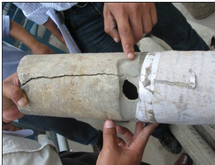
FIGURA 65. INADECUADA PERFORACIÓN EN TUBERÍA DE AC PARA INSERTAR VÁLVULA CORPORATION
