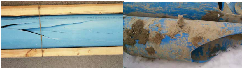
FIGURA 27. ROTURA FRÁGIL DE TUBERÍA DE PVC.
