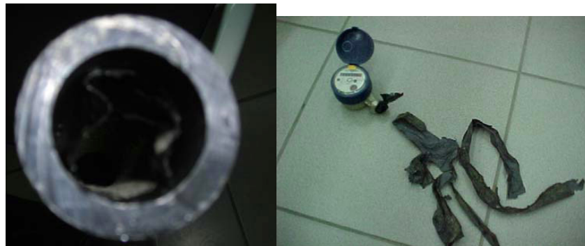
FIGURA 28. DECAPADO INTERNO DE LAS TUBERÍAS DE LDPE Y PROBLEMAS DE OBSTRUCCIÓN DE UN MEDIDOR DOMICILIARIO.
