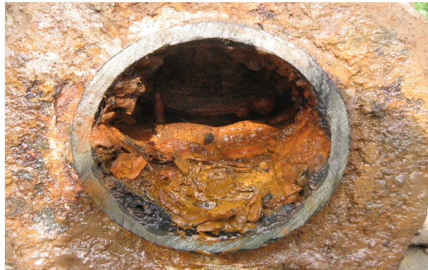
FIGURA 57. TUBERÍA DE AGUA POTABLE DE MATERIAL ASBESTO CEMENTO CON INCRUSTACIONES DE CARBONATOS (CALICHE)
