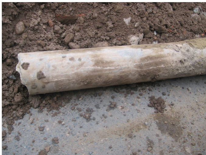
FIGURA 61. AGRIETAMIENTO Y COLAPSO DE TUBERÍA DE AC
