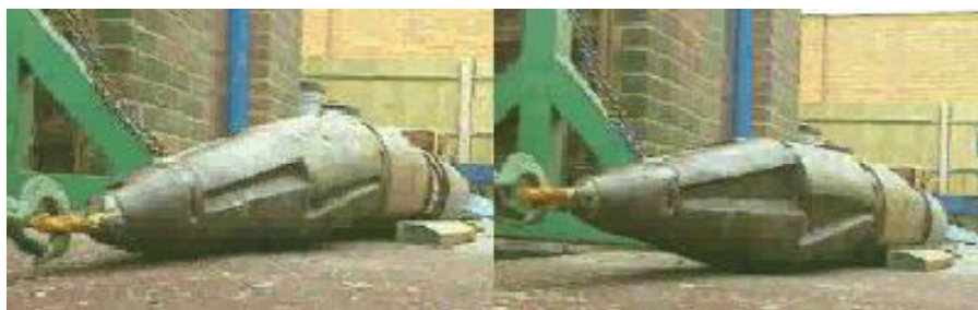
FIGURA G. 31. MOVIMIENTO DEL CABEZAL DE TIRO QUE PRODUCE LA ROTURA DE LA CONDUCCIÓN
