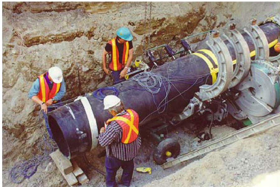
FIGURA G. 19. UNIÓN POR SOLDADURA DE UN TUBERÍA EN UNA CATA DE ENTRADA
