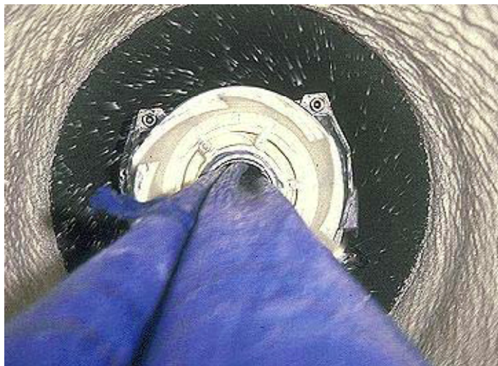
FIGURA G. 10. MECANISMO DE INYECCIÓN DE RESINAS QUE SIRVEN COMO REVESTIMIENTO NO ESTRUCTURAL.
