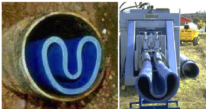
FIGURA G. 24. VISTA DE LA DEFORMACIÓN REALIZADA SOBRE LA TUBERÍA DE POLIETILENO Y UN EJEMPLO DE DEFORMACIÓN IN-SITU.
