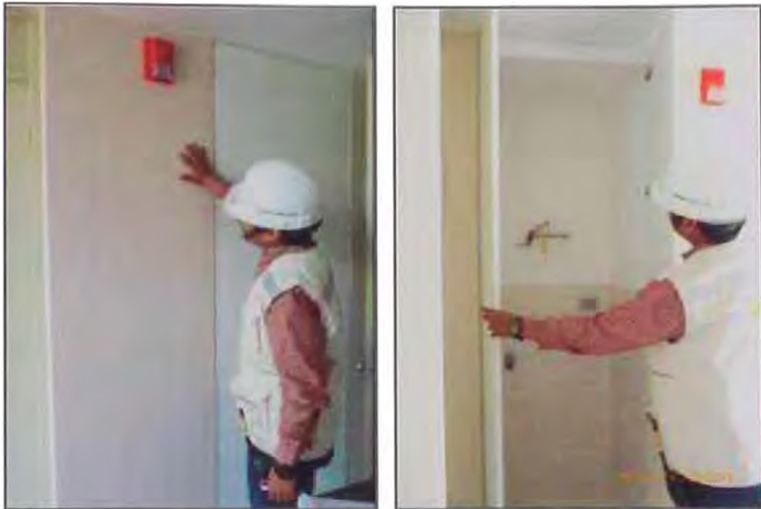
Figura 3.28: Revisión de papel mural y puertas de melamine en zona de lavandería
