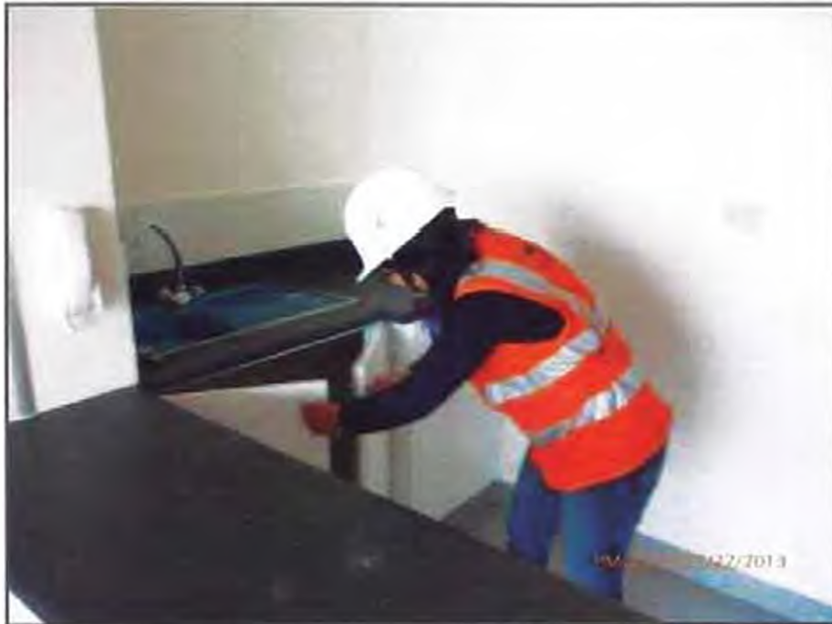
Figura 3.24: Revisión de muebles de cocina
