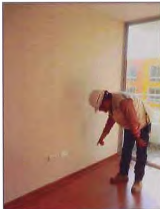
Figura 3.29: Revisión de piso laminado
