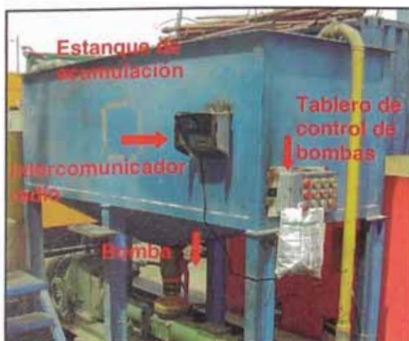
Fotografía 6.36: Estanque de acumulación, tablero de control de bombas y bomba de inyección.
