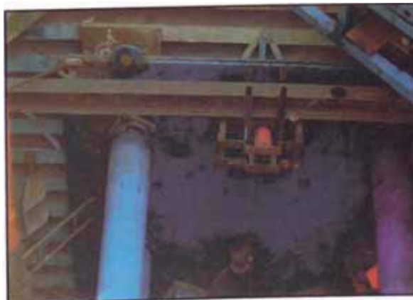
Fotografía 6.6: Láser alojado en el pórtico.
