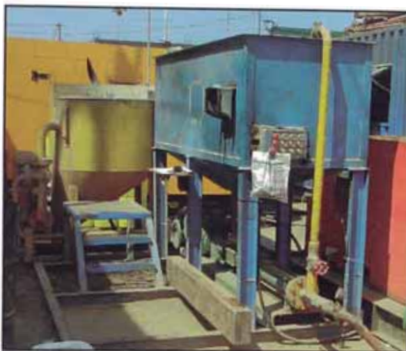
Fotografía 6.33: Equipo de Bentonita
