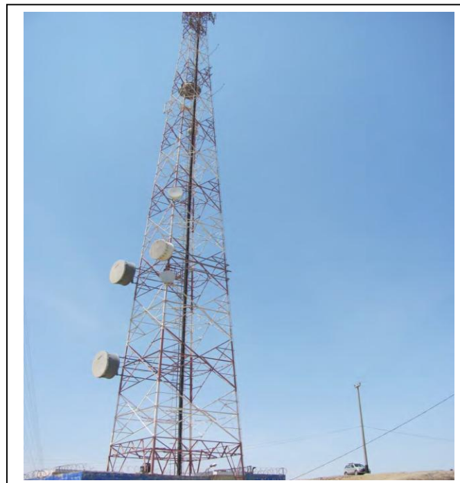
Fig. 4.2. Mástil de medición, torre de telefonía [8]
