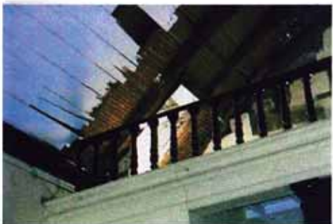
Deterioro del techo sobre el coro alto
