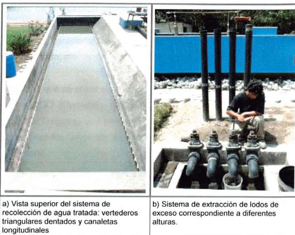
Figura 2.17: Vista del sistema de recolección de agua tratada y de la salida de lodos.
