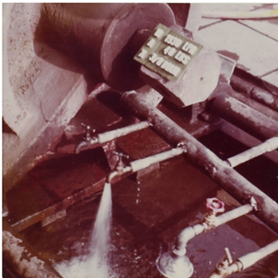
(c).- Salida de agua inmediata al medidor.
