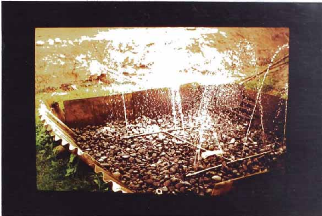
FOTOGRAFIA N° 4 FILTRO PERCOLADOR EN OPERACION
