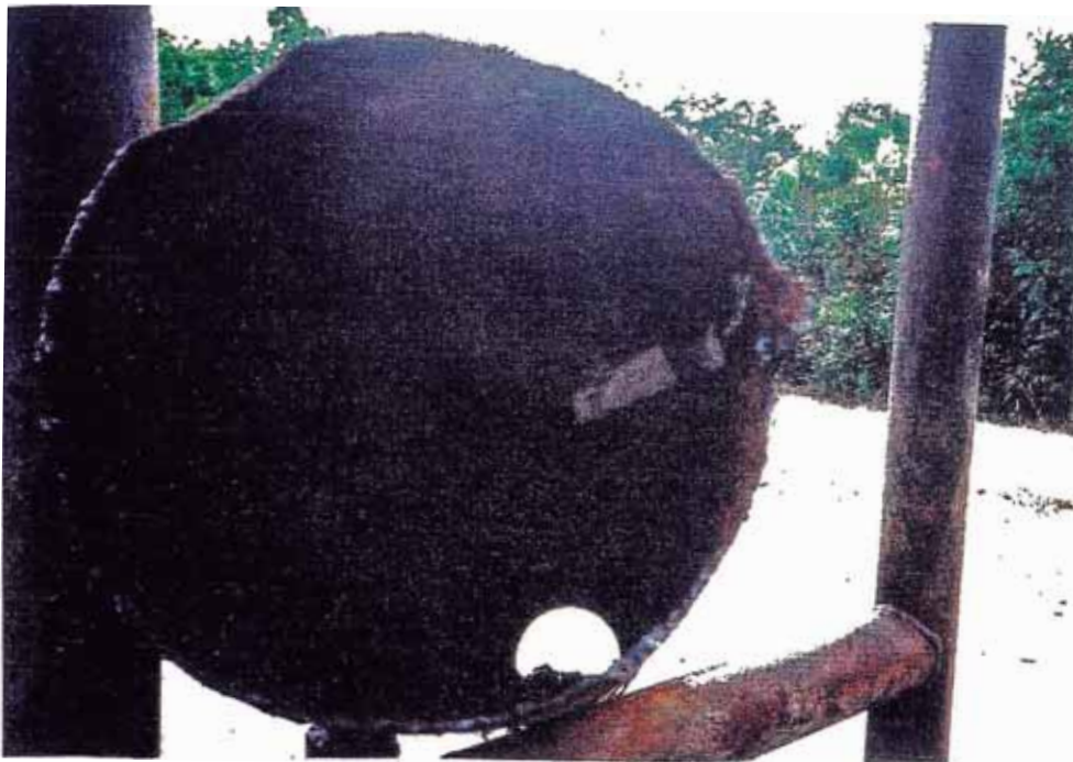
Foto 4: Grado de corrosión de tubería de impulsión N°1 de agua cruda
