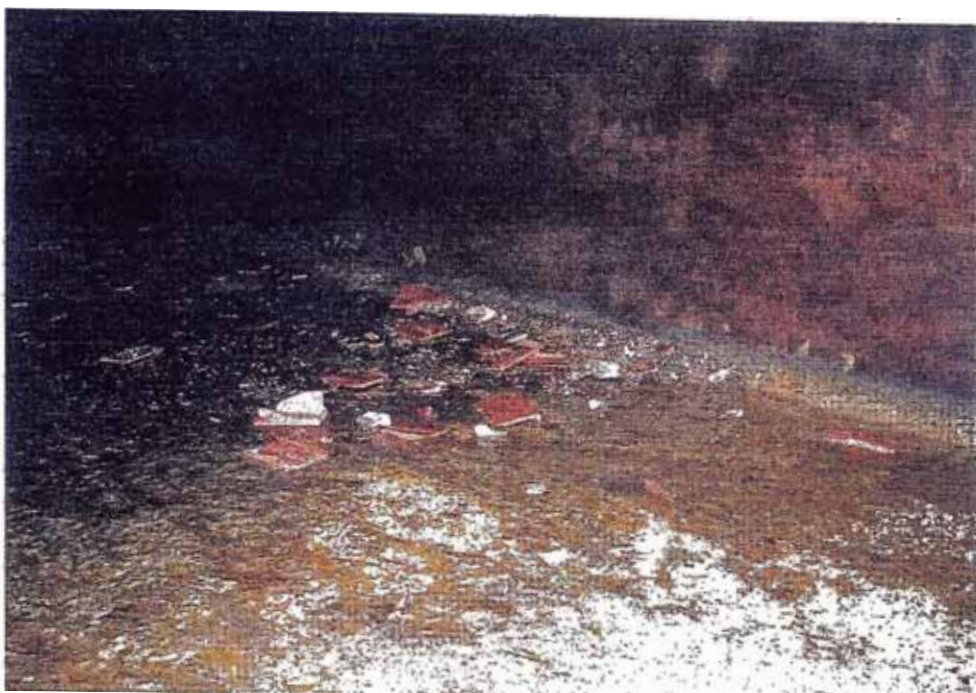
Foto 5: Ladrillos caídos del techo del reservorio N°2
