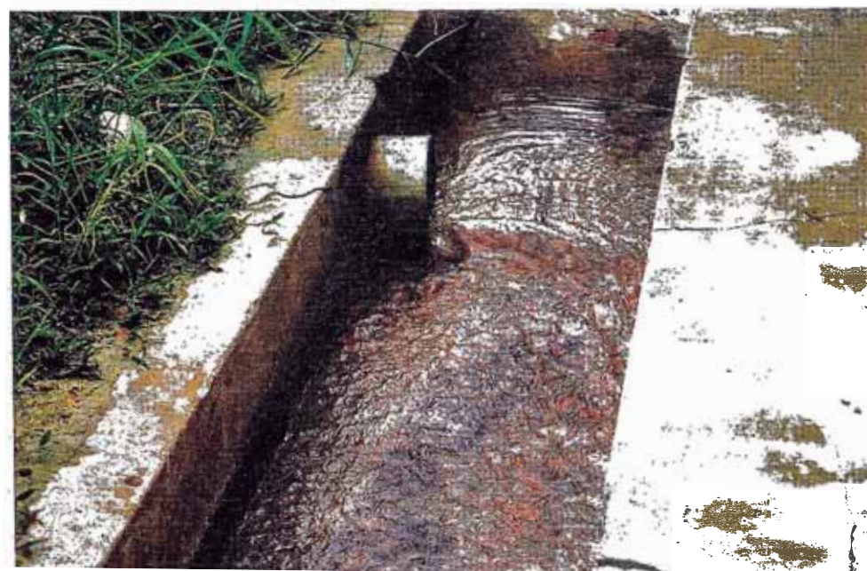
Foto 6: Pérdida de agua tratada de los reservorios (60 l/s)
