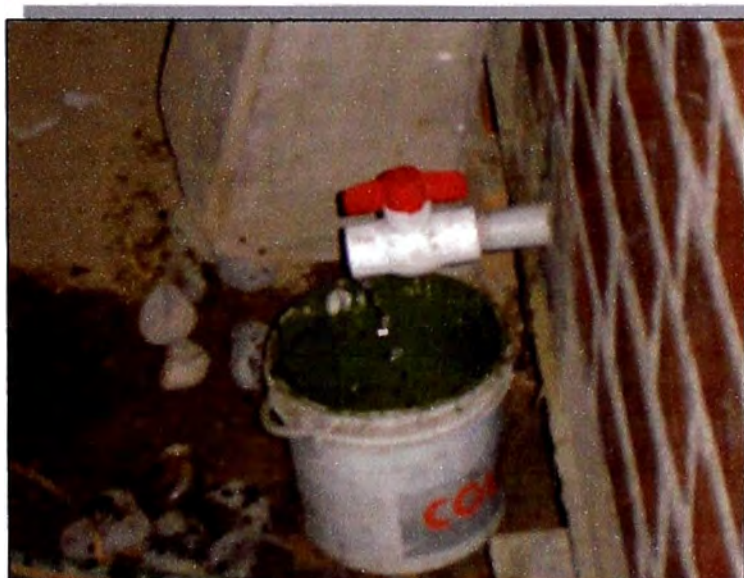
Foto N° 4.5.3: Válvula tipo compuerta para la recolección de lixiviados
