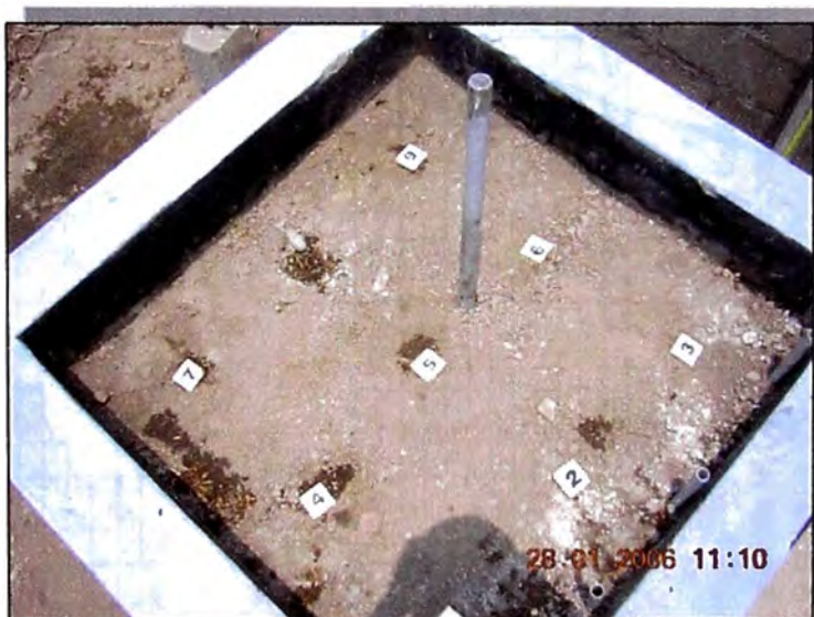
Foto 5.7.2 La medición de asentamientos se realizó en cada uno de los puntos ubicados en las celdas piloto.
