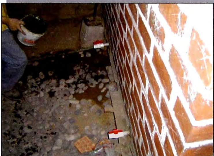
Foto N° 4.5.4: Válvulas colocadas en ambas Celdas Piloto para la recolección de lixiviados
