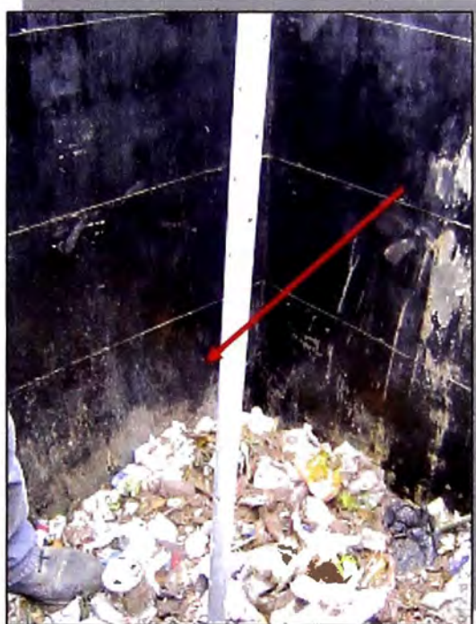
Foto N°4.5.13: Tubería de PVC, perforada que recolecta los gases producidos.
