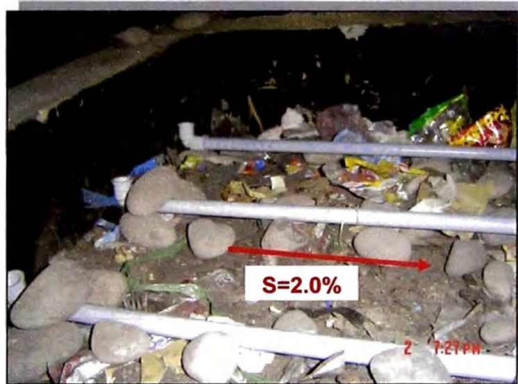
Foto N° 4.5.17: Pendiente de las tuberías de distribución de lixiviado recirculado.
