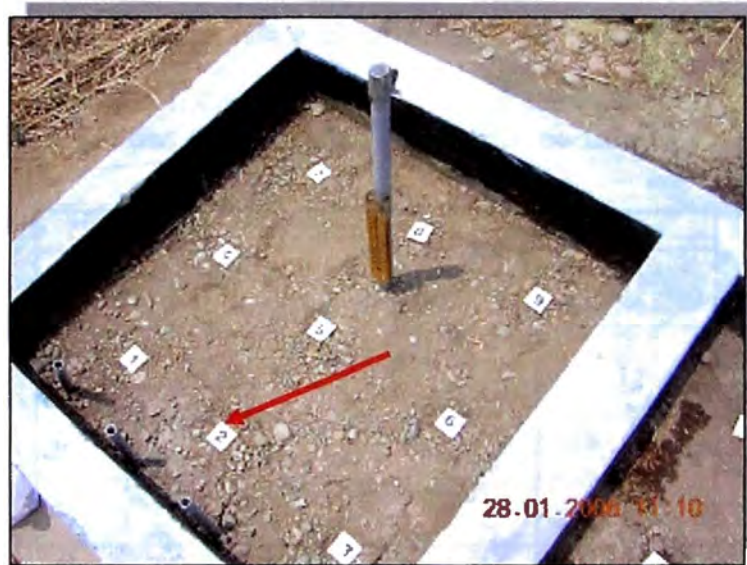
Foto N° 4.5.22: Dispositivos de medición de asentamientos distribuidos en forma equidistante en la superficie de las celdas piloto.
