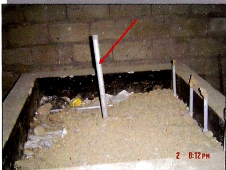
Foto N° 4.5.14: Parte final de la tubería de evacuación de gases generados en Celdas Piloto.
