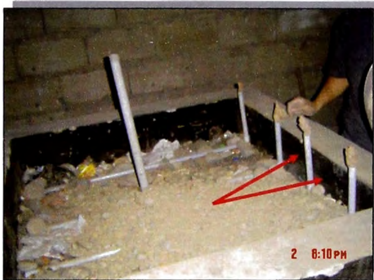
Foto N° 4.5.19: Tuberías de 25cm de PVC para la distribución de lixiviado recirculado.
