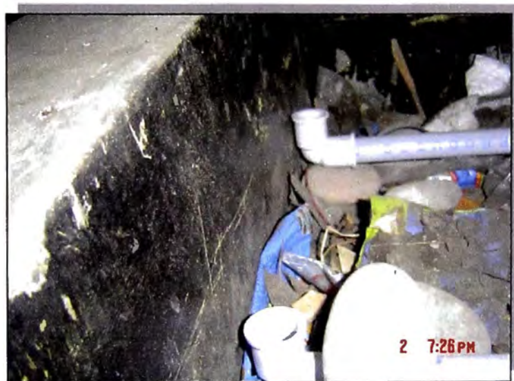
Foto N° 4.5.18: Codos de PVC para la distribución de lixiviado recirculado.
