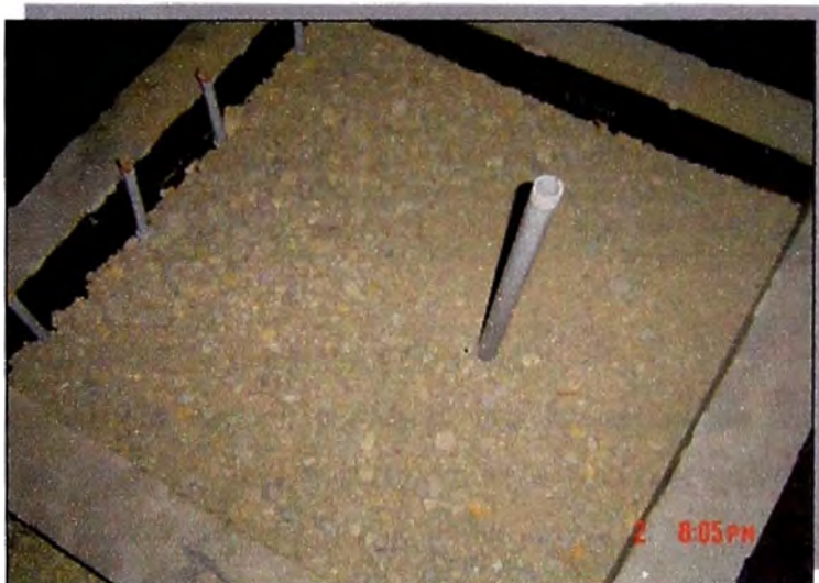
Foto N° 4.5.21: Material de cobertura en la parte superior de las celdas piloto, compuesto de tierra y material granular.
