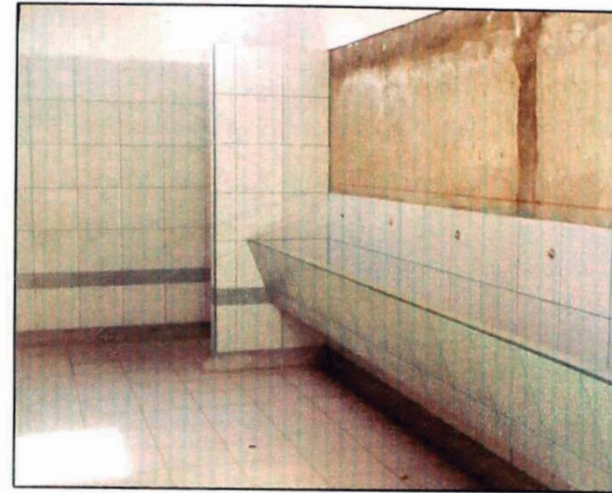
LAVATORIO DEL SS.HH. DE DAMAS
