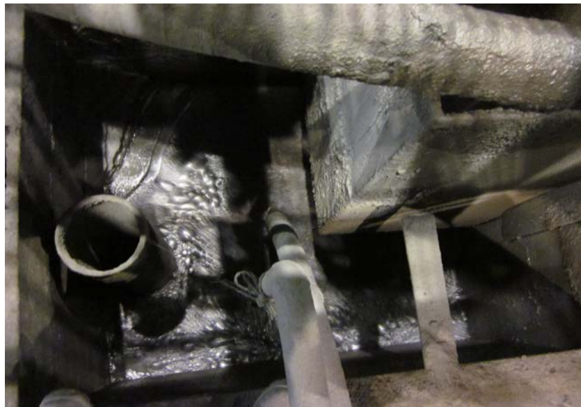
Fig. 4.5 Cajón de descarga del molino 8x10
