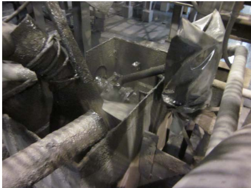
Fig. 4.2 Cajón distribuidor en la descarga del molino 8'x10'
