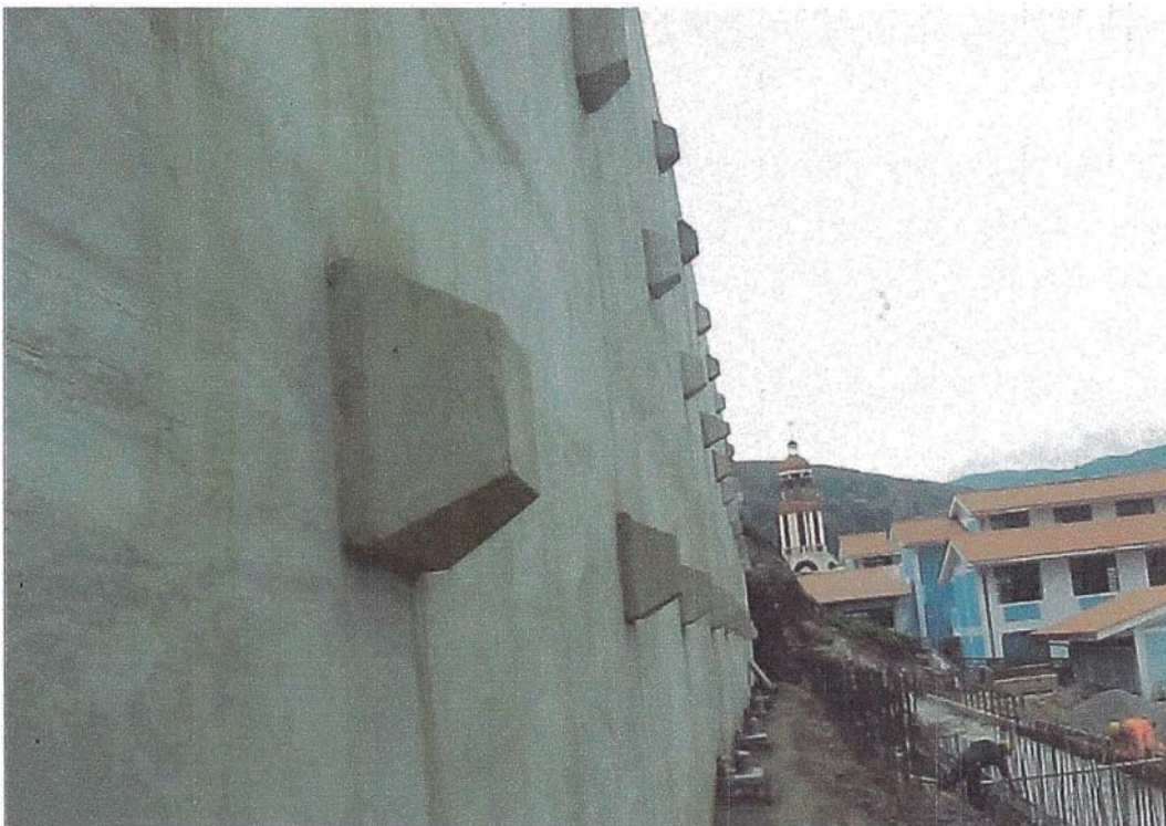
Figura N°3.28.- Vista del Estado Final de Anclajes Efectuados en la Obra de la I.E. 86019 la Libertad
