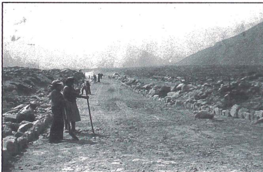
Foto (16). Habilitación de las principales vías de acceso a la quebrada de Huaycán.
