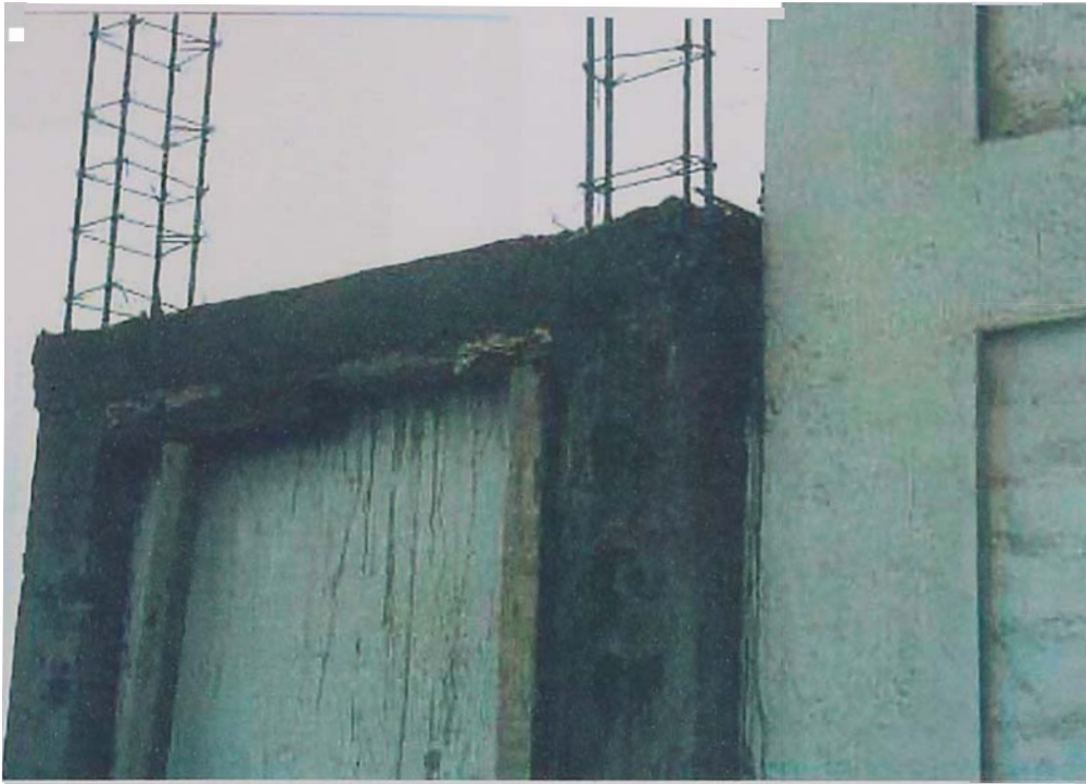
Foto N° 07.- No hay simetría de columnas. Columnas de poca sección y no poseen el recubrimiento mínimo del acero, el cual se encuentra especificado en la norma E- 060- Cap. VII del R.N.C..
