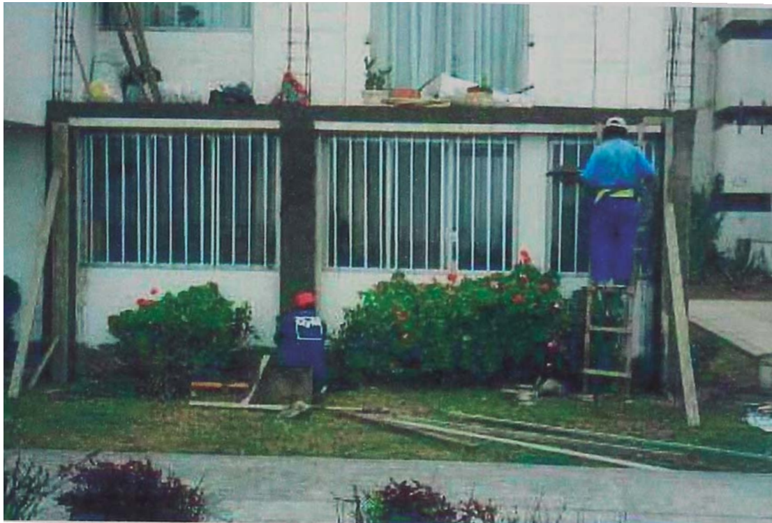
Foto N° 05.- No hay junta de dilatación entre losa existente y la nueva
