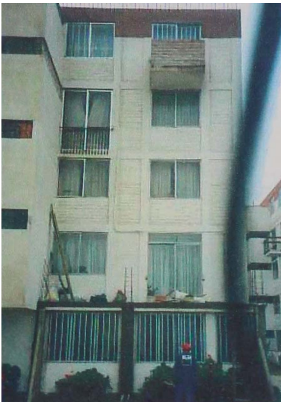
Foto N° 04 .- En el 2 do. Nivel existía un balcón como se aprecia en el 5to. Nivel. Pero el propietario del 2do. Nivel aprovecha el techo del 1er. Nivel para ampliar el área de balcón sin la autorización del propietario de 1er nivel. Construcción que se realiza en forma rápida
