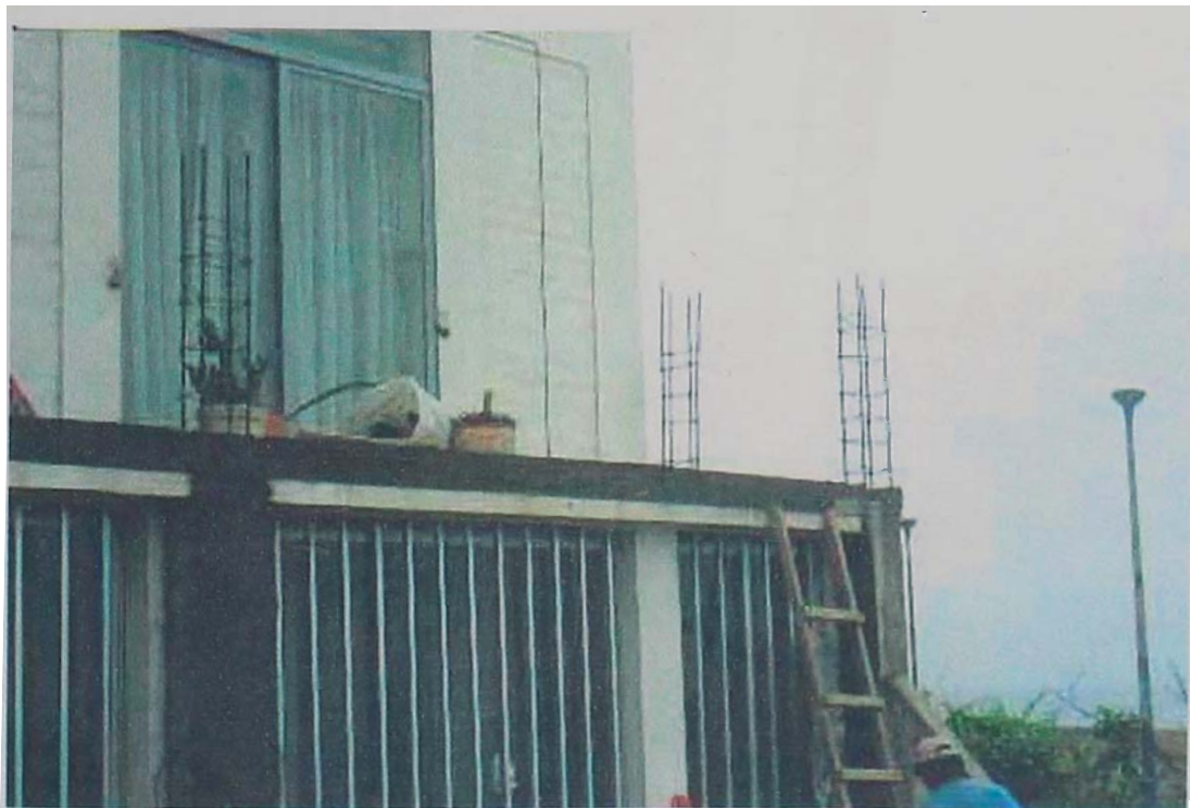
Foto N° 06.- Construcción que se realizan en poco tiempo sin asistencia de profesionales en las debidas autorizaciones
