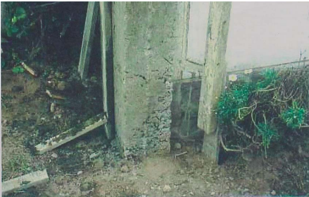
Foto N° 08.- Las secciones pequeñas de la columna imposibilitan el buen acomodo del concreto. A consecuencia de ello, han provocado cangrejera que debilitan y reducen la resistencia del concreto
