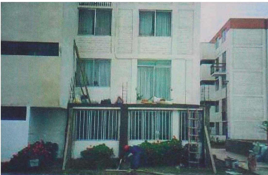
Foto N° 02.- Puntos críticos que no garantizan e tabilidad de la nueva construcción que pro ocan daños en la estructura exi tente
