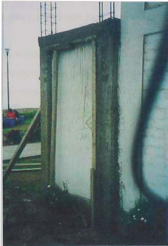
Foto N° 10 Columna que sale fuera del perímetro del Edificio.
