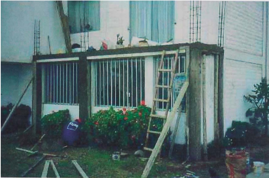
Foto N° 01.- No existen detalles de anclaje de la nueva construcción en viga del edificio
