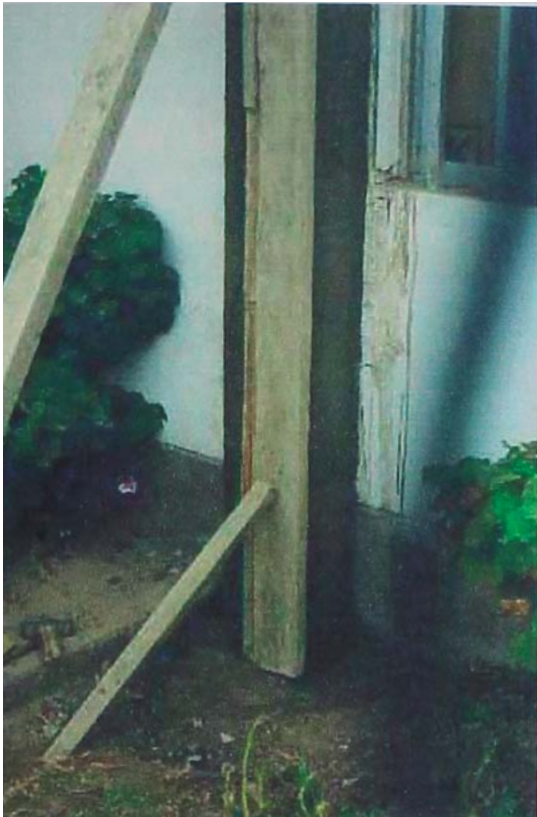
Foto N° 03.- No se aprecia juntas de dilatación entre la columna nueva y la construcción existente
