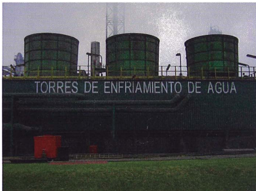
Gráfico N° 20: Torre de enfriamiento de tiro inducido
