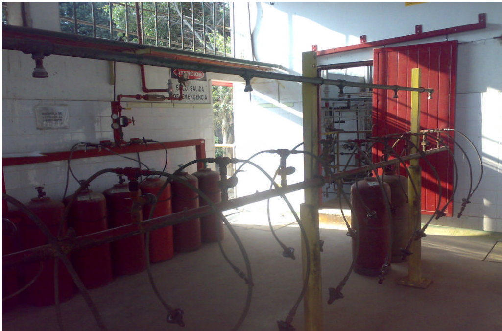
ACCESO A SALA DE GENERACIÓN DE ACETILENO – BATERÍA DE RETORNO AL GENERADOR Y BATERIA DE LLENADO DE CILINDROS
