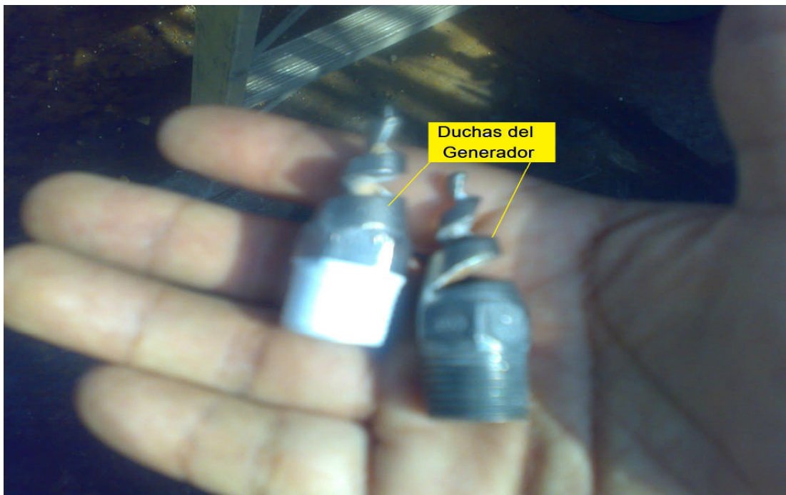
DUCHAS DE INGRESO AGUA EN GENERADOR DE ACETILENO
