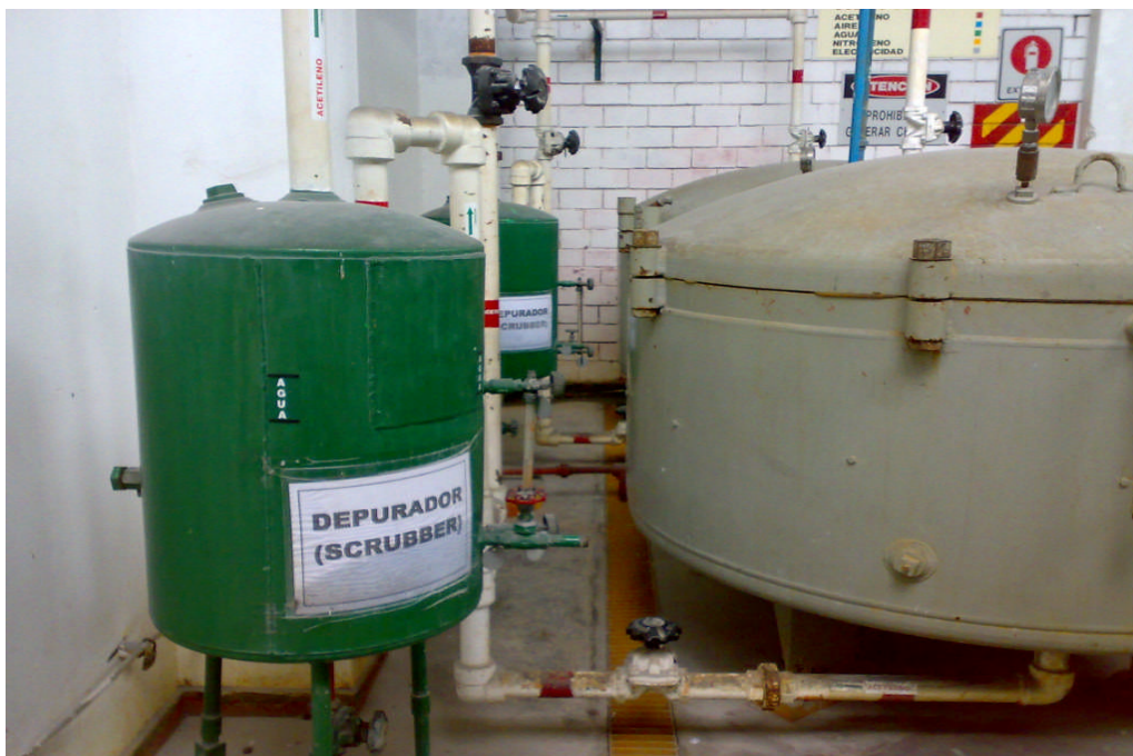
LAVADOR DE GASES (SCRUBBER)
