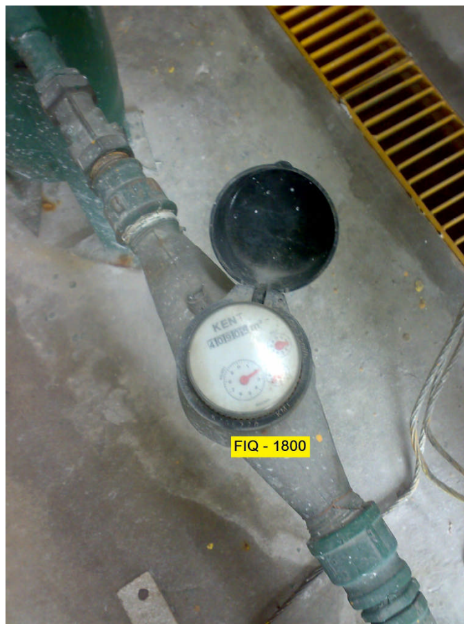
INDICADOR DE INGRESO DE AGUA AL GENERADOR DE ACETILENO
