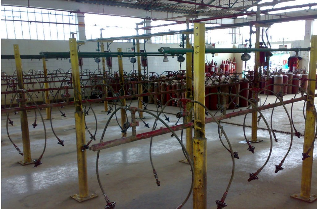
BATERÍA DE LLENADO DE CILINDROS DE ACETILENO
