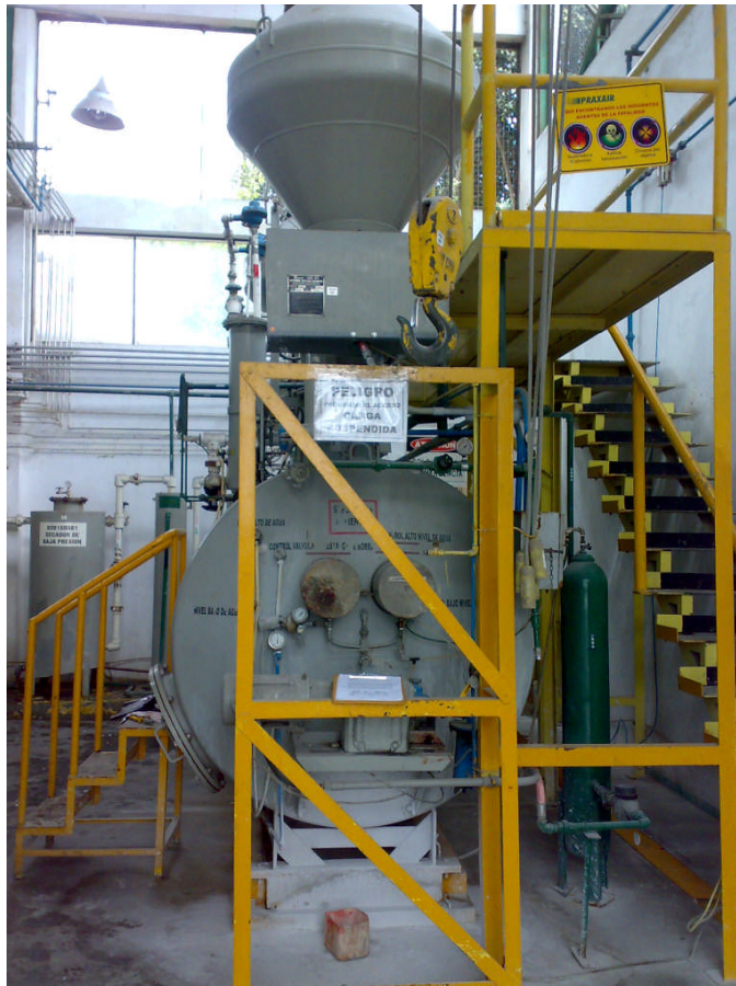
GENERADOR DE ACETILENO – RAMPA DE ACCESO HOOPERS
