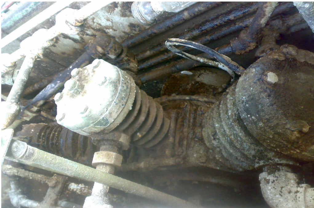
VISTA INTERNA DEL COMPRESOR DE 3 ETAPAS
