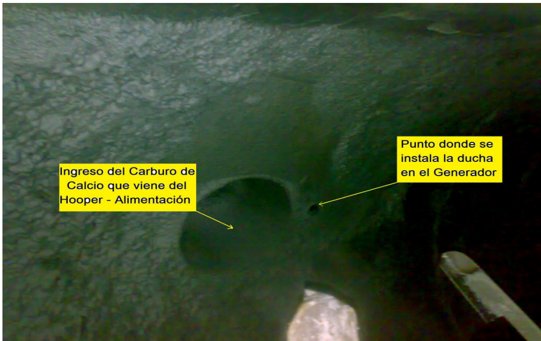
UBICACIÓN INGRESO DE AGUA Y CARBURO DE CALCIO – GENERADOR
