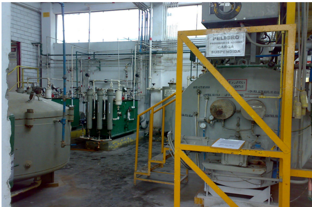
GENERADOR DE ACETILENO – VISTA LATERAL
