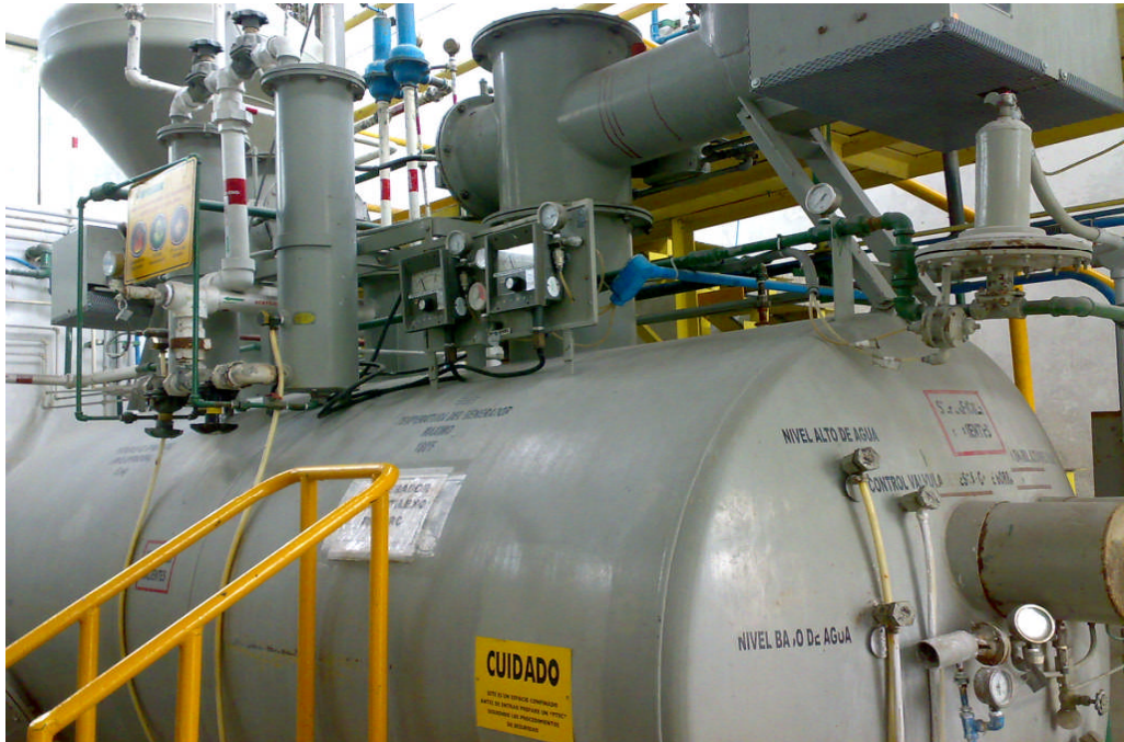
GENERADOR DE ACETILENO – VISTA LATERAL
