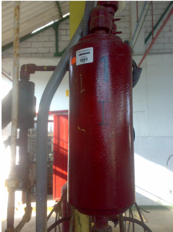
FLASH ARRESTOR – BATERÍA DE LLENADO DE CILINDROS
