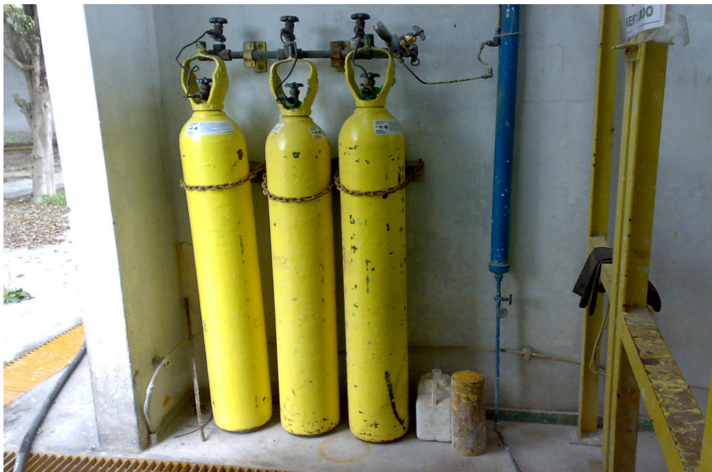
BATERÍA DE CILINDROS DE NITRÓGENO PARA INERTIZACIÓN
