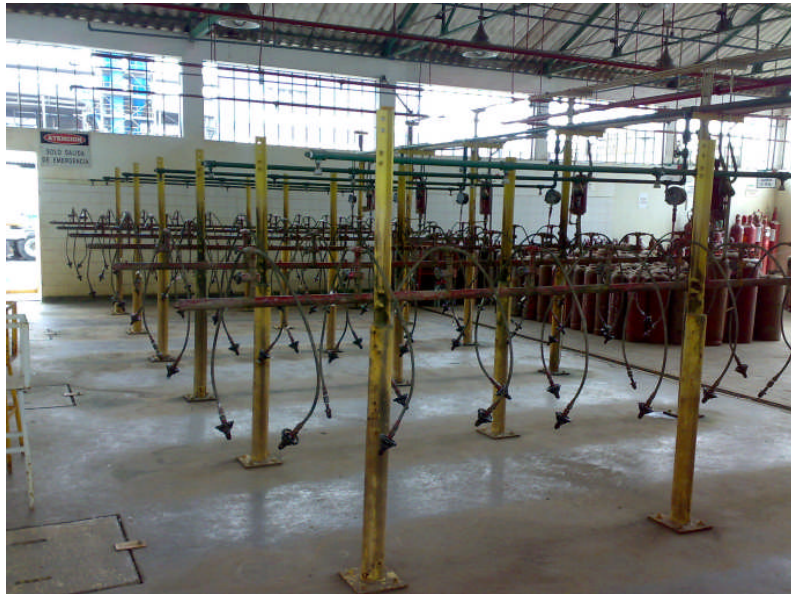
Baterías de Llenado de Cilindros
