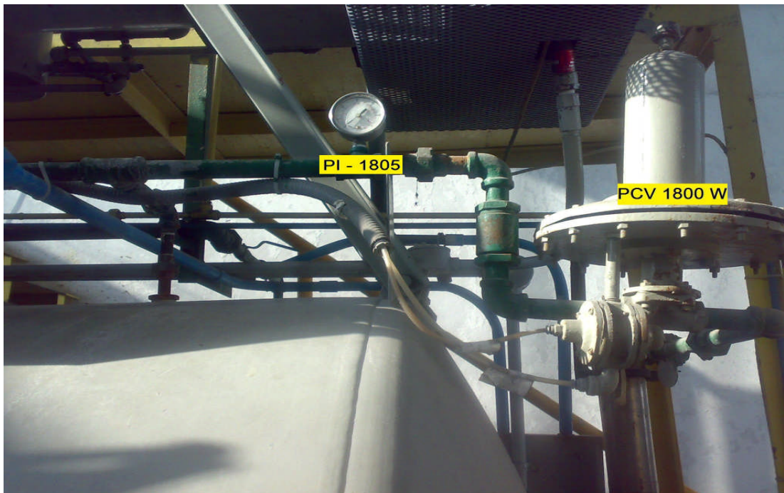
INDICADOR DE PRESIÓN EN INGRESO DE AGUA AL GENERADOR DE ACETILENO Y VÁLVULA DE DIAFRAGMA
