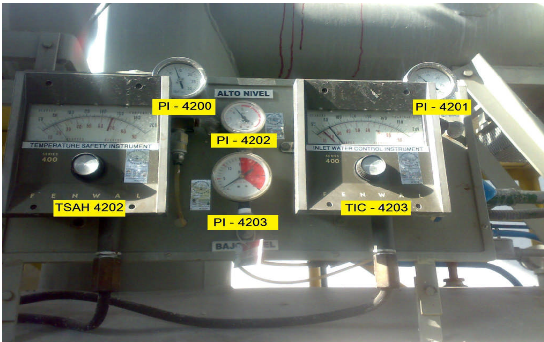
PANEL DE CONTROL – GENERADOR DE ACETILENO
