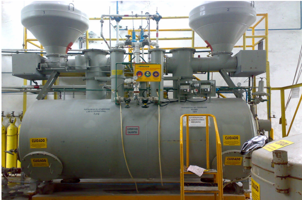
GENERADOR DE ACETILENO – VISTA DE FRENTE
