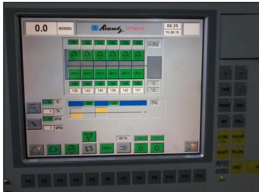
Figura 32. Pantalla de panel de control- Panel izquierdo
