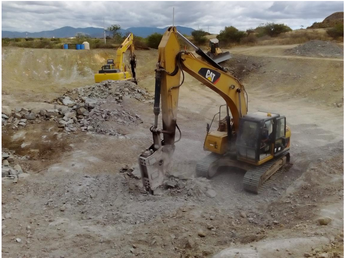
Foto N° 11: Excavación de pozas de colección y monitoreo del sistema de drenaje superficial.
