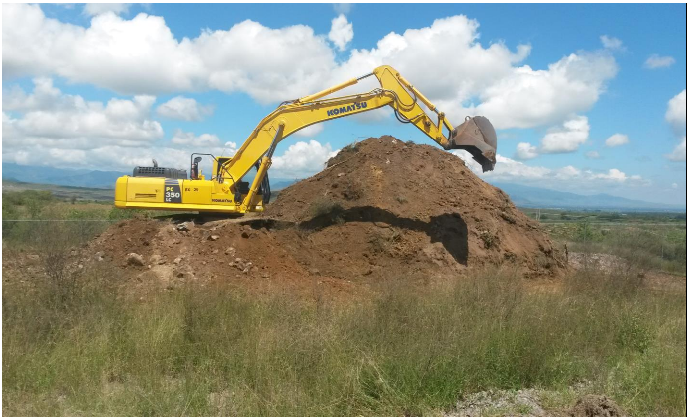
Foto N° 2: Despalle de la cobertura vegetal en área de pozas de colección y monitoreo.
