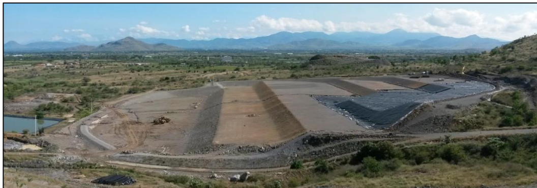
Fotografía 3-5: Vista panorámica de los trabajos de impermeabilización de la cimentación del depósito de relaves filtrados (segunda etapa de construcción).
