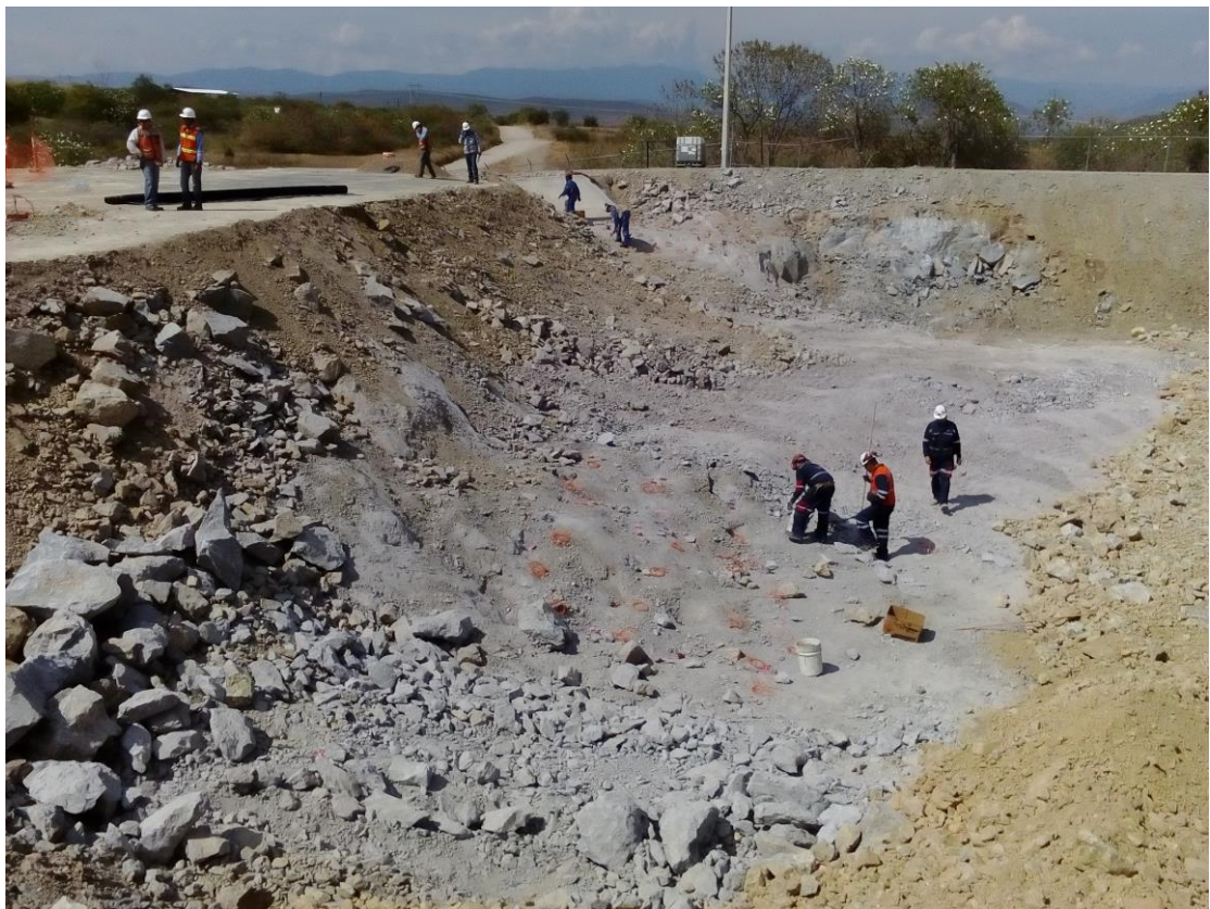
Foto N° 12: Trabajos de carguío de barrenos en poza del sistema de drenaje superficial.
