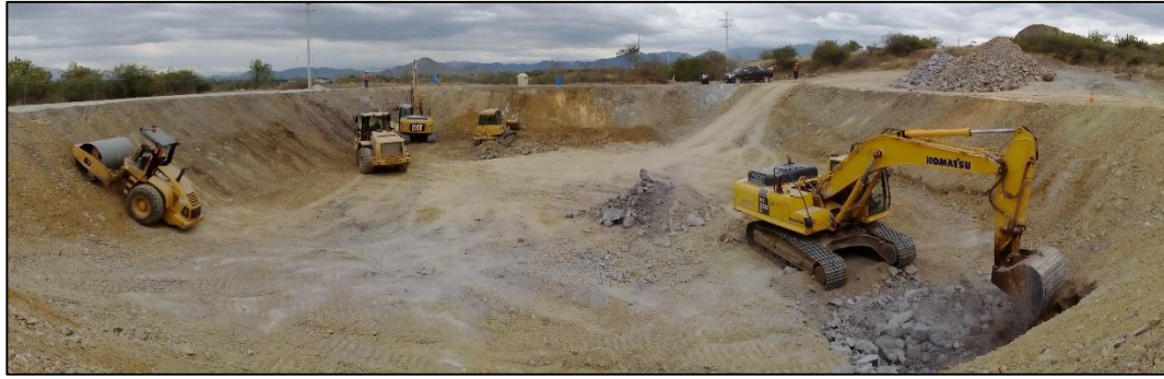
Fotografía 3-10: Construcción de pozas de colección y monitoreo del sistema de drenaje superficial.
