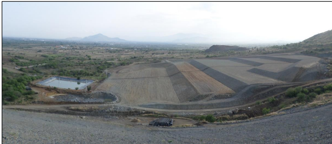
Fotografía 3-1: Vista panorámica de la cimentación del depósito de relaves filtrados (Final de la primera etapa de construcción).
