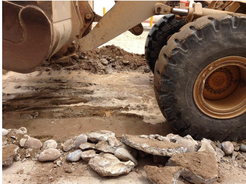
FIGURA N° 3-1: MOMENTO DE ROTURA DE TUBERÍA DE AGUA
