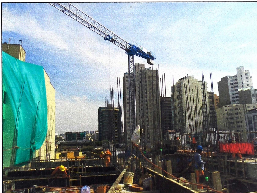
Figura Nº 4.13 Vista de la grúa torre instalada en el frontis de la obra.
