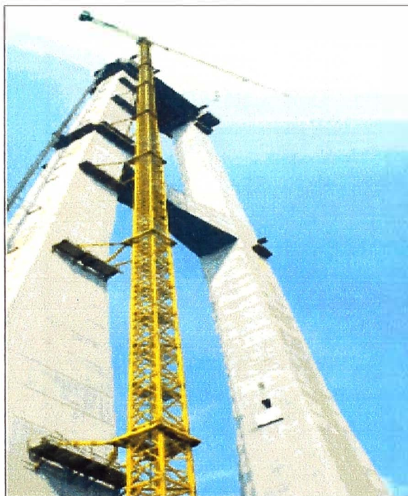
Figura N° 2.4 Grúa Torre trepadora.
