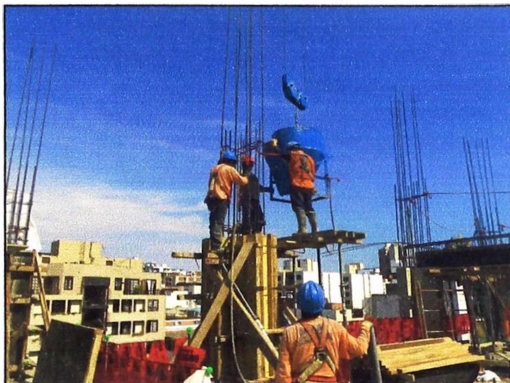
Figura N° 4.14 Vaciado de concreto en elementos verticales con el uso de la grúa torre.
