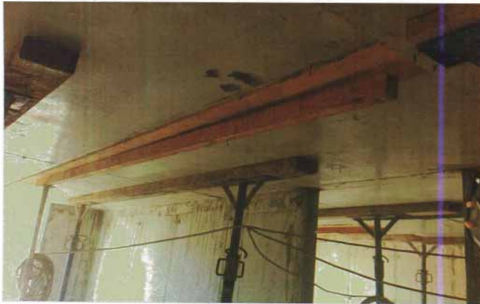
Figura N°48: deflexiones de losas
