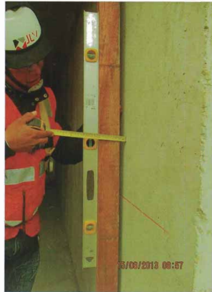
Figura N°40: Fotografía muro desplomado
