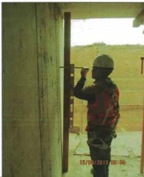
Figura N° 18: desaplome de muro
