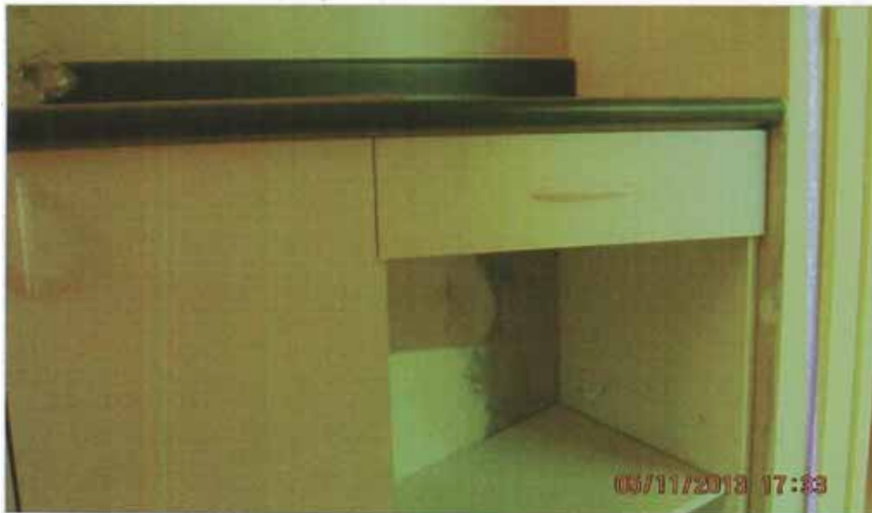
Figura N°36: Fotografía de mueble colocado sin que el muro este pintado
