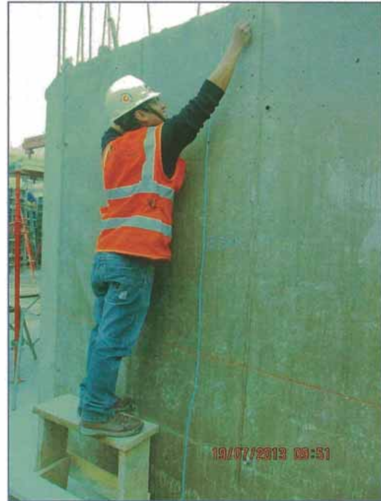
Figura N°51: altura excesiva de placas
