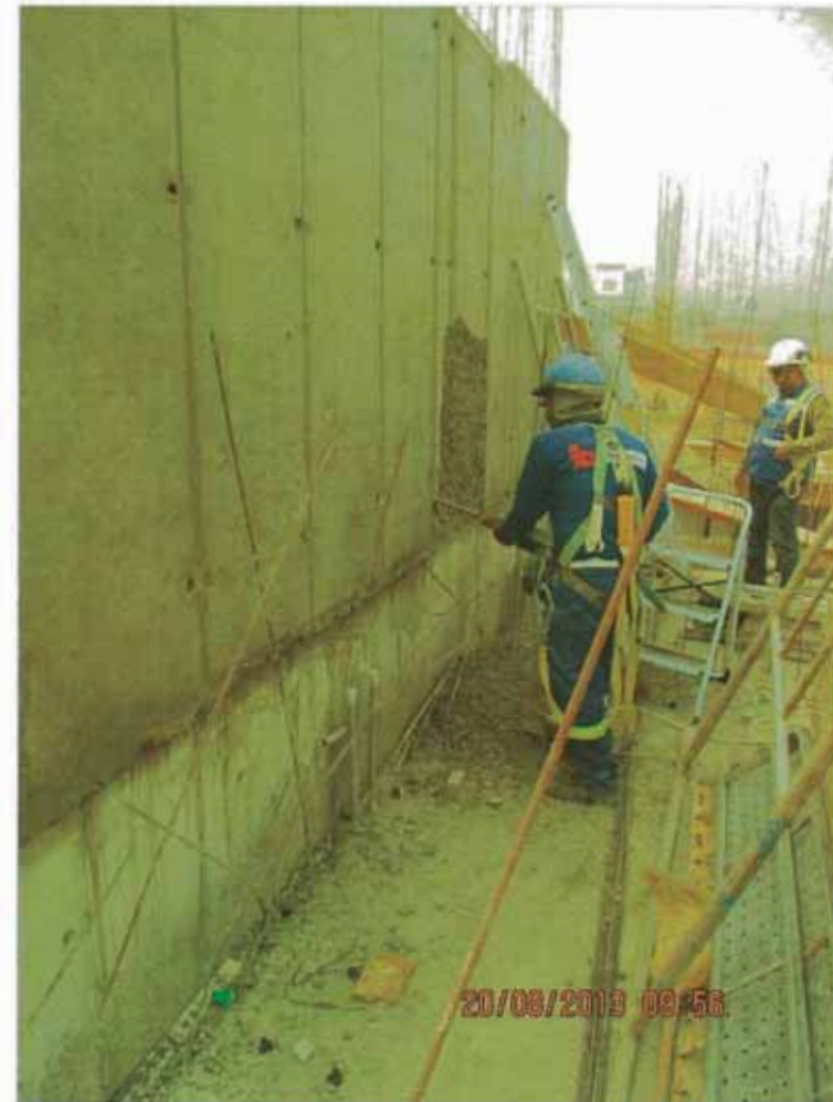
Figura N°43: Fotografía de desplome en fachada
