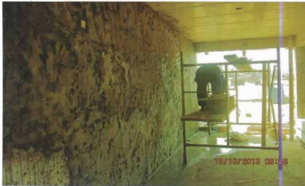
Figura N°39: Tarrajeo sobre muro que debió ser solaqueado
