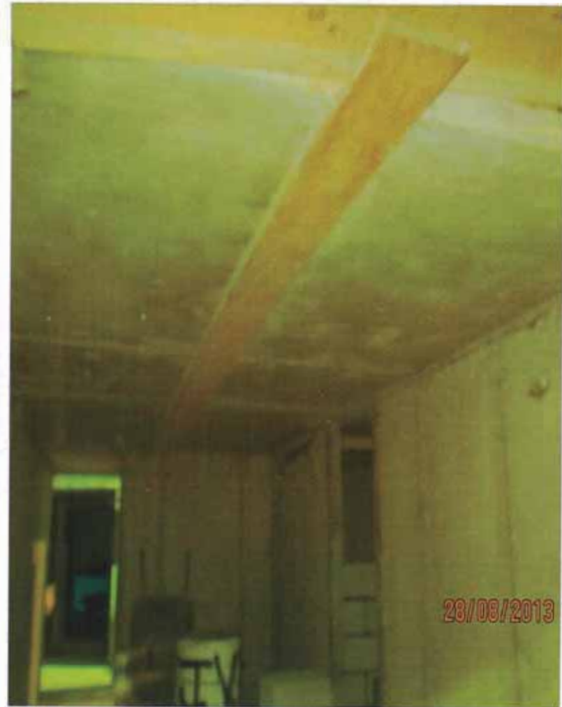
Figura N°49: deflexiones de losas
