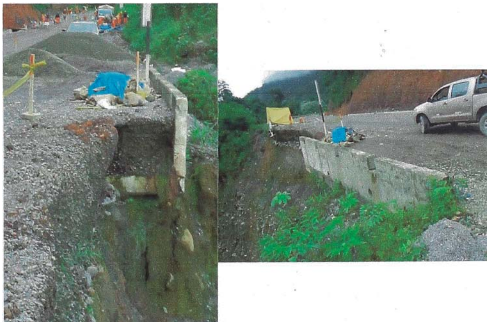
Figura 1.8. Muro de contención parcialmente colapsado.
