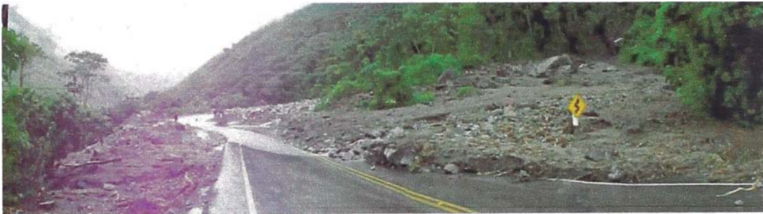
Figura 2.12. Deslizamiento ocurrido en la progresiva 255+620.
