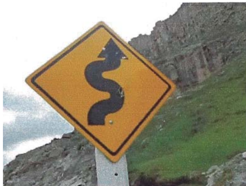
Figura 1.13. Señal dañada detectada durante una evaluación.
