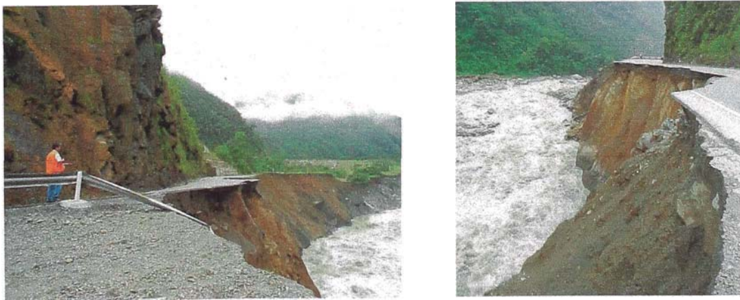
Figura 2.13. Deslizamiento ocurrido en la progresiva 263+930.
