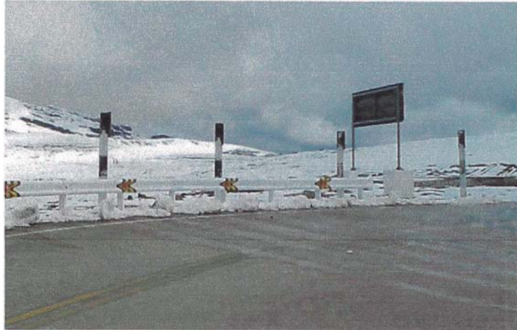
Figura 2.14. Sector de la vía sometida al efecto de hielo y deshielo.
