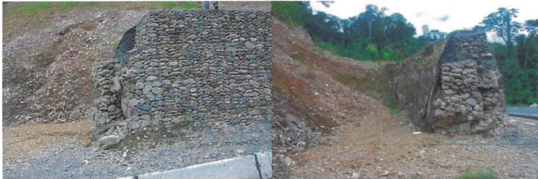
Figura 1.7. Gaviones dañados, vistas frontal y lateral.
