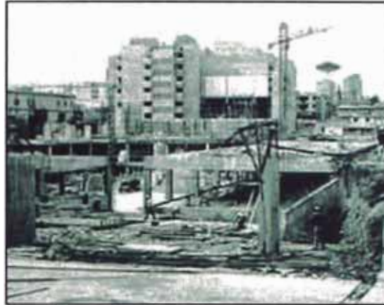
Figura. N°1.2 Grúa Torre en la Construcción del la Torre del Centro Cívico vista 1.
