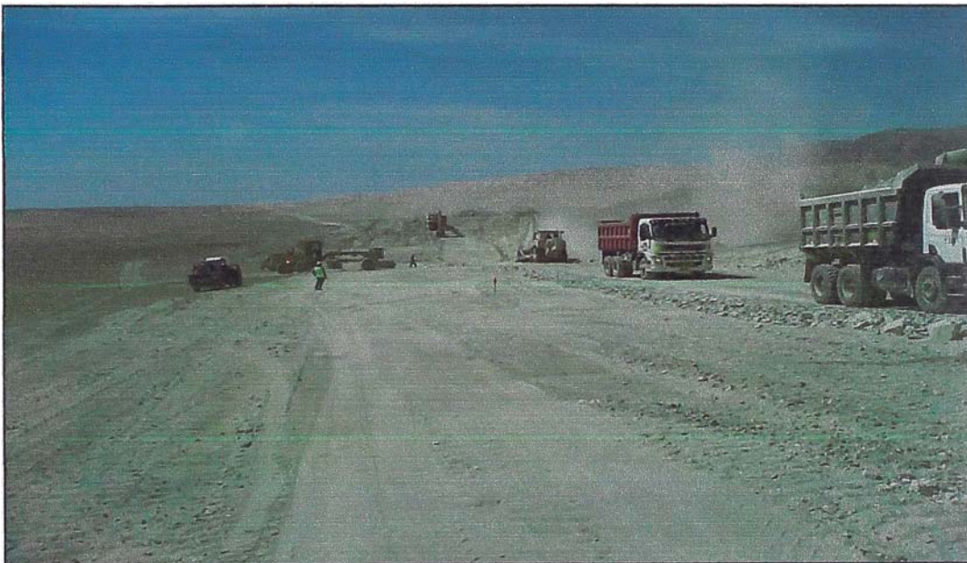
Figura N° 2.4: Fotografía de trabajos de explotación de cantera y transporte de Material para rellenos (Gaseoducto troncal Ica-Nazca)
