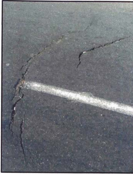
Figura 4.5 – Grietas de borde nivel medio.
