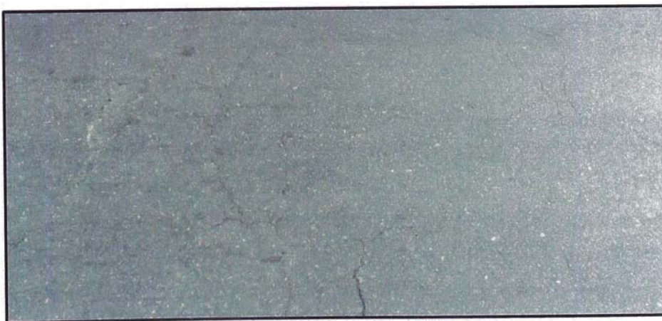
Figura 4.4 – Fisuramiento de nivel moderado.
