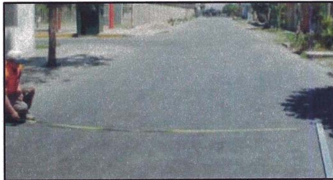
Figura 4.7 – Levantamiento en campo de daños. Método PCI. (Foto referencial)
