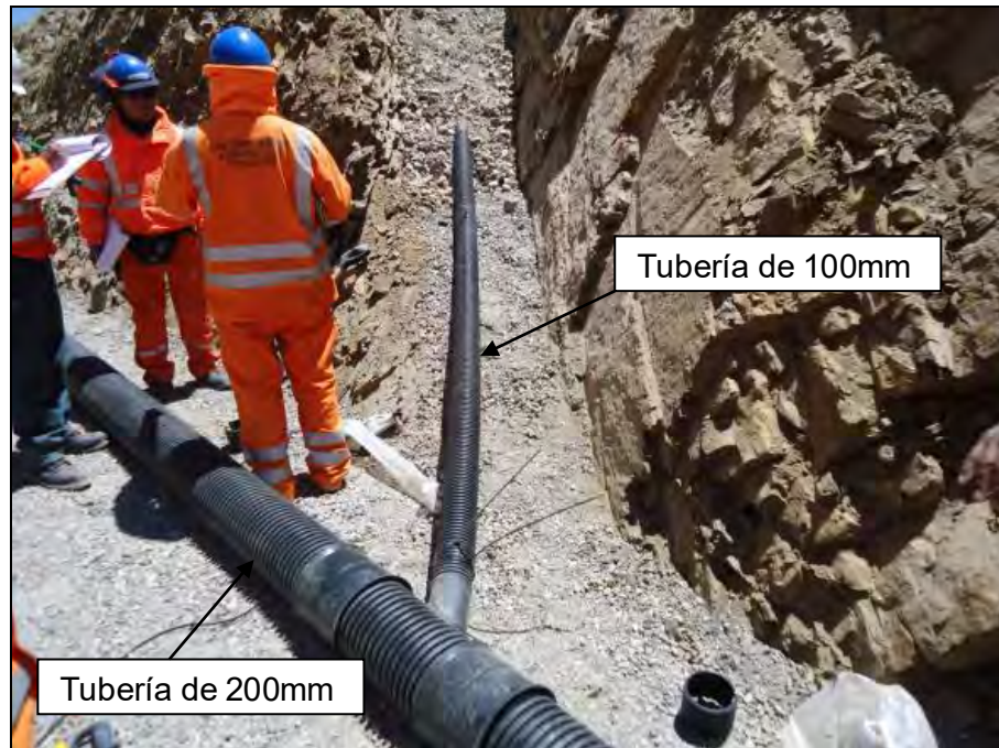
Fotografía N° 7 - Unión típica de tuberías (Ver plano 200-03 y 200-10, en Anexo D)
