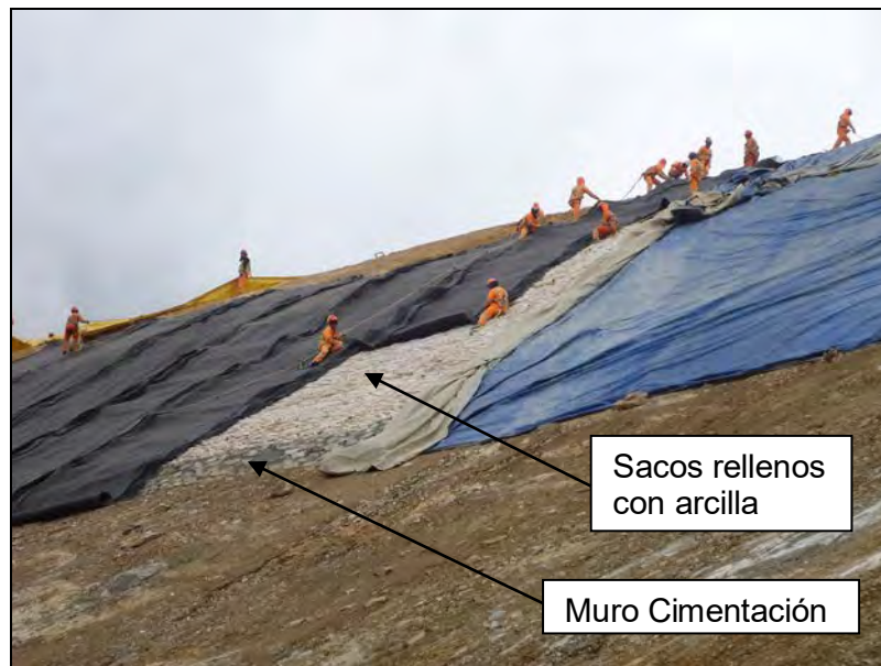
Fotografía N° 27 –Colocación de sacos rellenos con arcilla para uniformizar parte del talud superior
