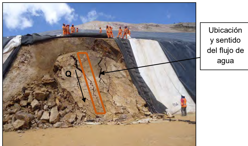
Fotografía N° 25 - Zona de derrumbe por aparición de agua subterránea
