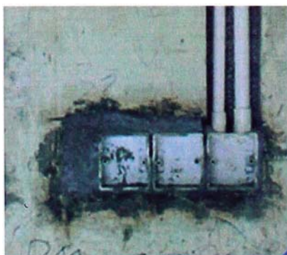
Fig. 2.24: Detalle de instalaciones eléctricas
