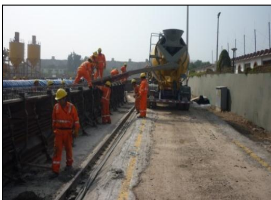
Fig. 124. En el diseño no se consideró que el nivel de altura de los encofrados dificultaría el vaciado de los elementos en forma directa con el camión.
