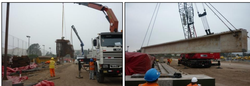
Fig. 39. Traslado de mallas de acero a zona de producción y traslado de vigas a zona de stock
