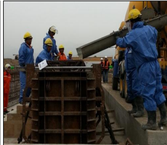
Fig. 127. Mixer de concreto sobre plataforma a desnivel en área de producción.
