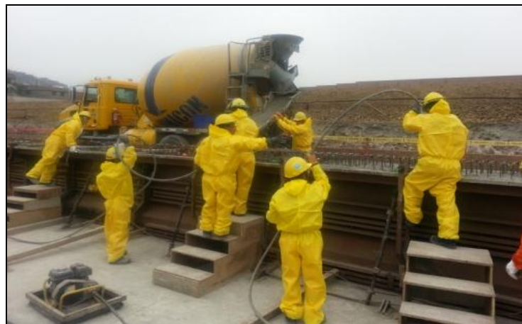
Fig. 128. En la planta de prefabricados del tramo 2, se implementó mejoras en el proceso de armado de acero, encofrado y vaciado de concreto de las vigas prefabricadas.
