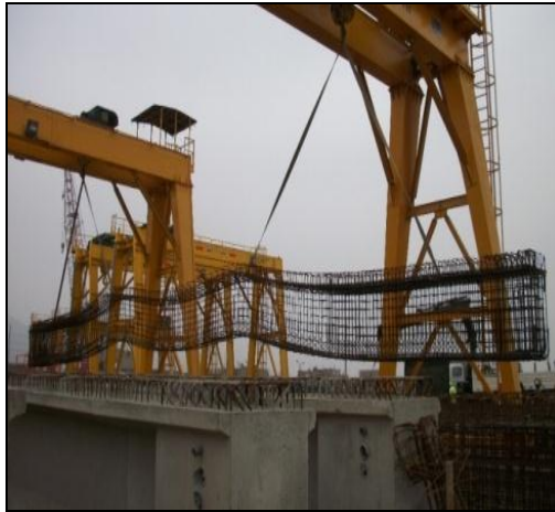
Fig. 126. Traslado de armadura de acero de viga pretensada con grúa tipo pórtico.
