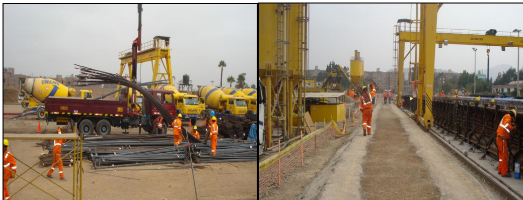
Fig. 50. Se muestra el acarreo de material con la ayuda del camión grúa y forma manual.
