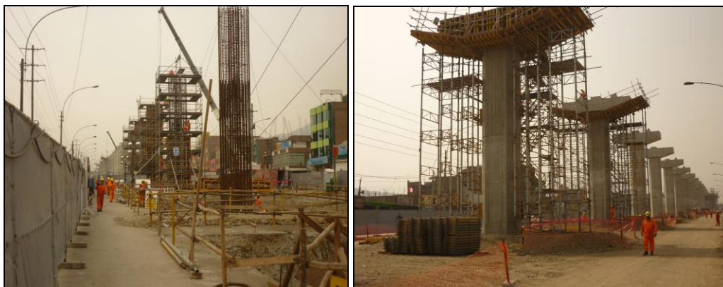
Fig. 3. Imagen izquierda muestra el proceso constructivo desde las excavaciones. Fig. 4. Imagen derecha muestra proceso constructivo hasta viga cabezal.
