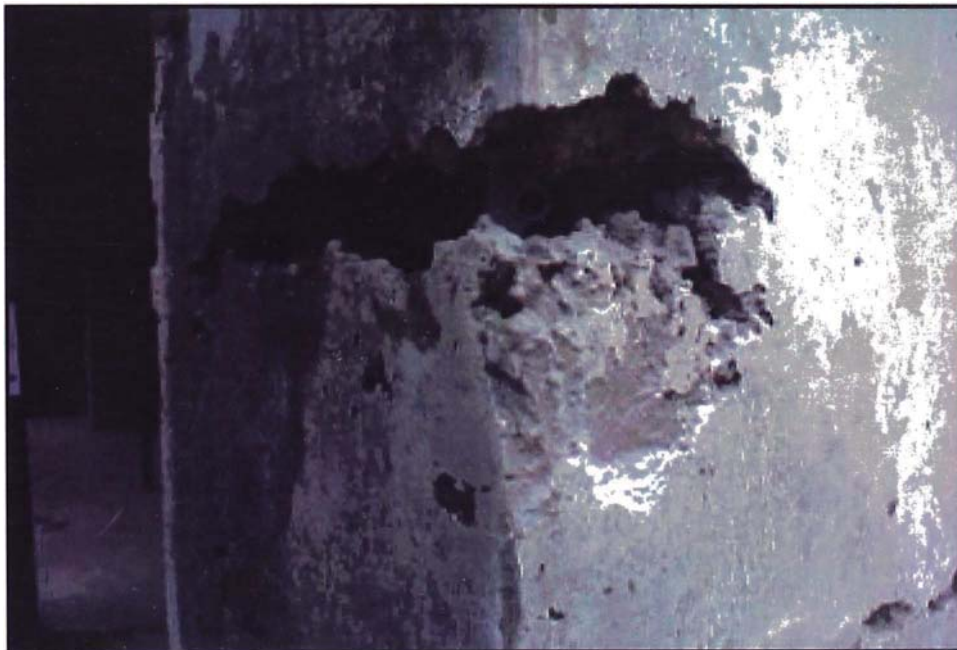
FIGURA N°. 7: DEFECTO DE CANGREJERA.
