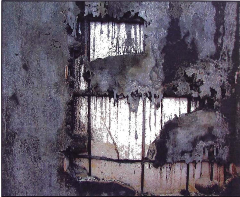
FIGURA N°. 8: DEFECTO DE CAVERNA.
