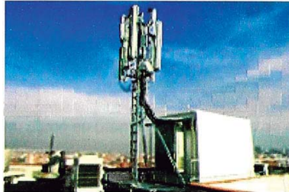
Fotografía1: Estación Base Celular urbana
