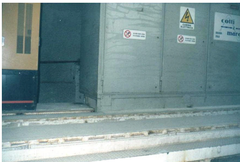
Fotografía N° 3-23: Cabinas eléctricas sobre el back up de la “TBM”.
