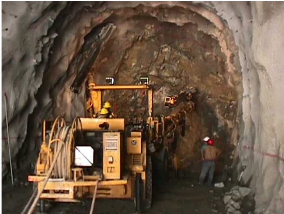
Fotografía N° 6-2: Jumbo hidráulico Rocket Boomer 282 perforando en el túnel de aducción N° 4 (ventana 3).
