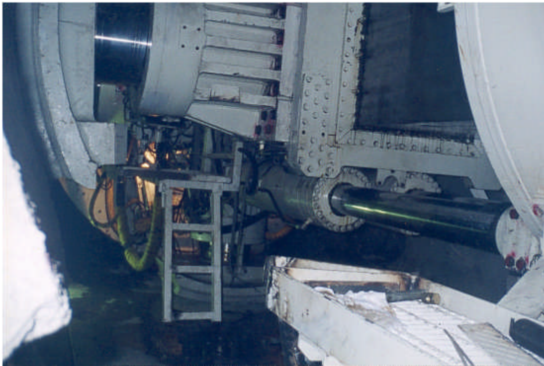
Fotografía N° 3-13: Cilindros de empuje inferiores mostrando su carrera de 1,5 m.
