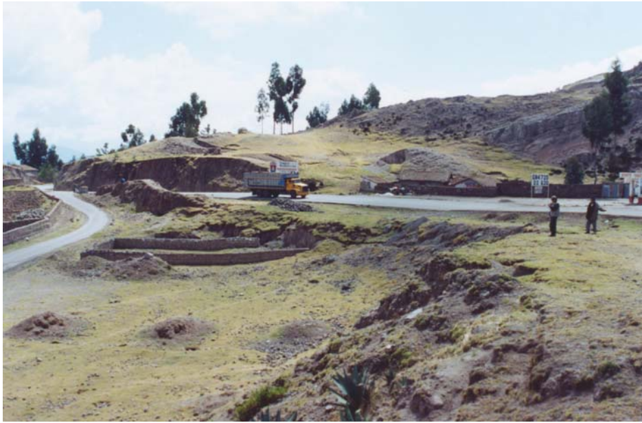
Foto N° 7.- Escarpa de deslizamiento en Rancho, Provincia de Huamanga, Departamento de Ayacucho, en el km 322 + 000 carretera Libertadores, es un deslizamiento activo donde en cada temporada de lluvias la carretera se asienta.
