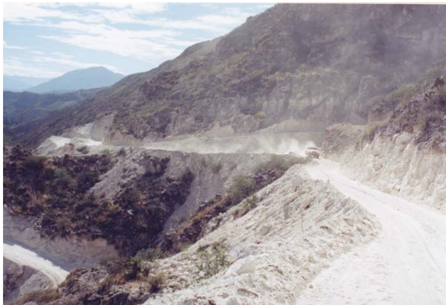
Foto N° 25.- Impacto en la calidad del aire debido a la construcción de trochas carrozables en materiales volcánicos que al estado seco levantan partículas muy finas que dañan la mucosa, trocha carrozable Huamanga-Quinua.
