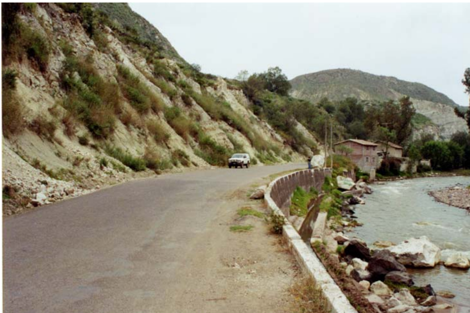
Foto N° 6.- Derrumbes sector Chacco, Provincia de Huamanga, carretera asfaltada Huamanga-Huanta, margen derecha río Occopa, el material del talud está constituido por areniscas y limolitas.
