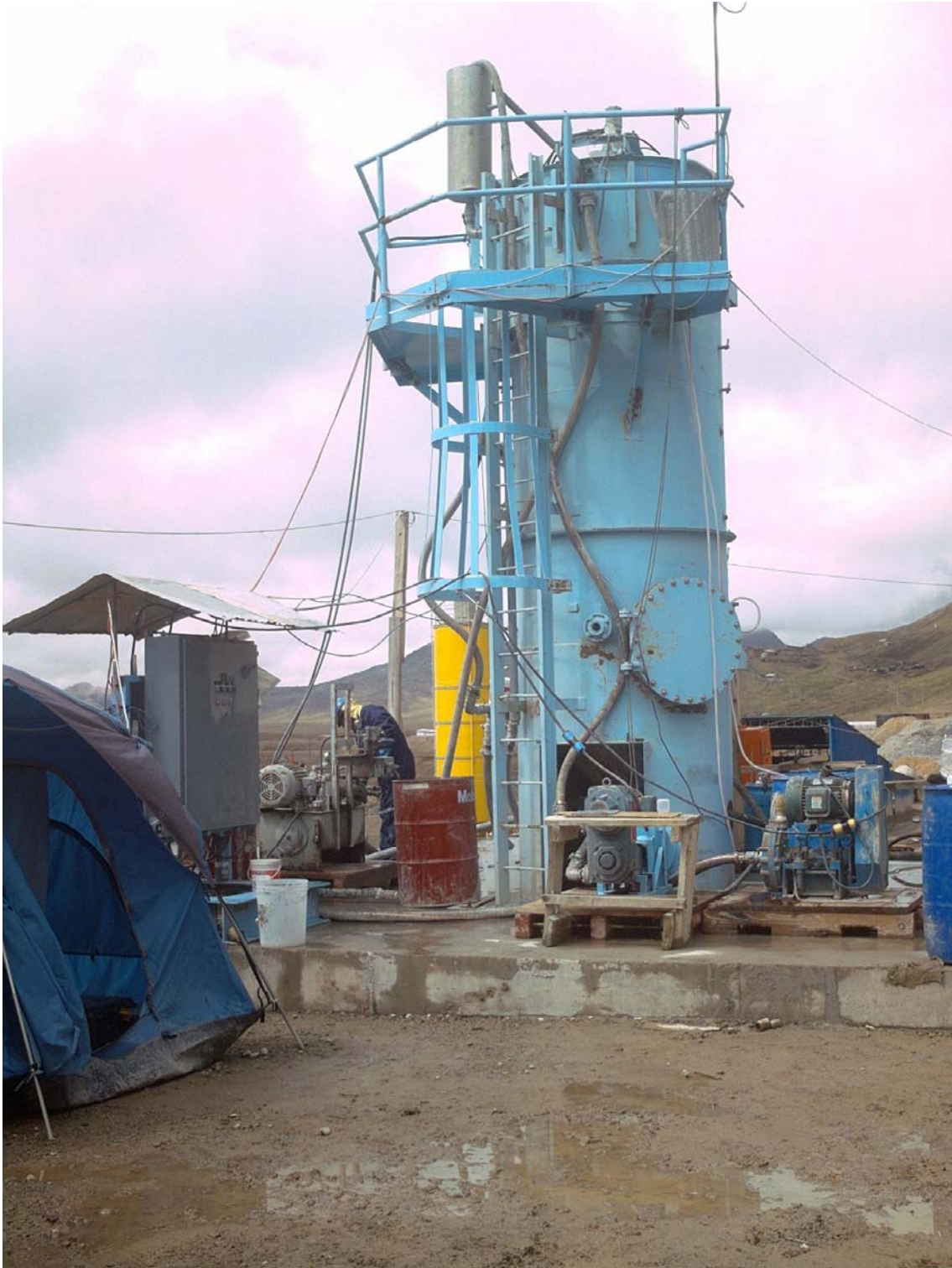
FOTOGRAFIA III.1: PLANTA PILOTO INSTALADA EN ANIMON – EACH SAC, PARA EL TRATAMIENTO INTEGRAL PILOTO DE AGUAS RESIDUALES INDUSTRIALES.
