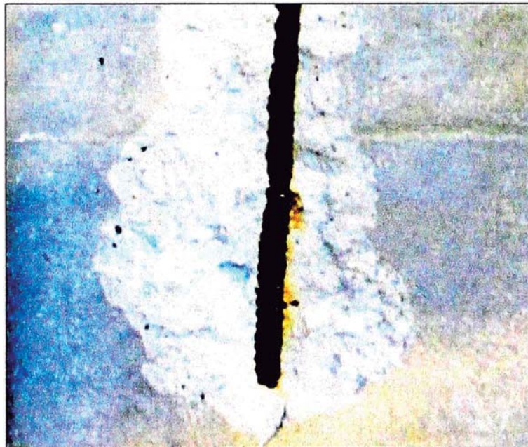
Fig. 1 La carbonatación del concreto puede dejar expuesta las varillas metálicas, permitiendo su oxidación.
