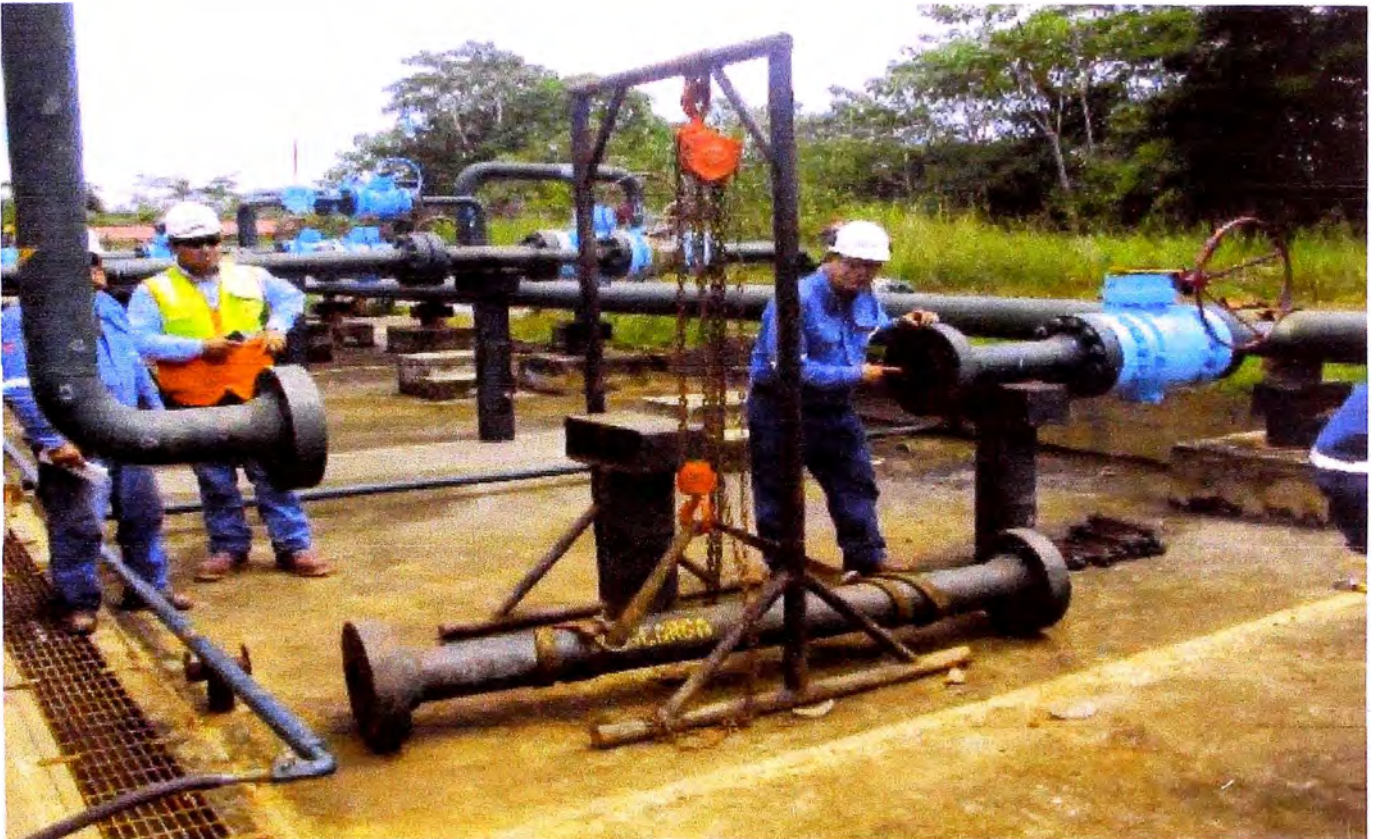
Fig. 3.5 Tubería con tramos embridados
