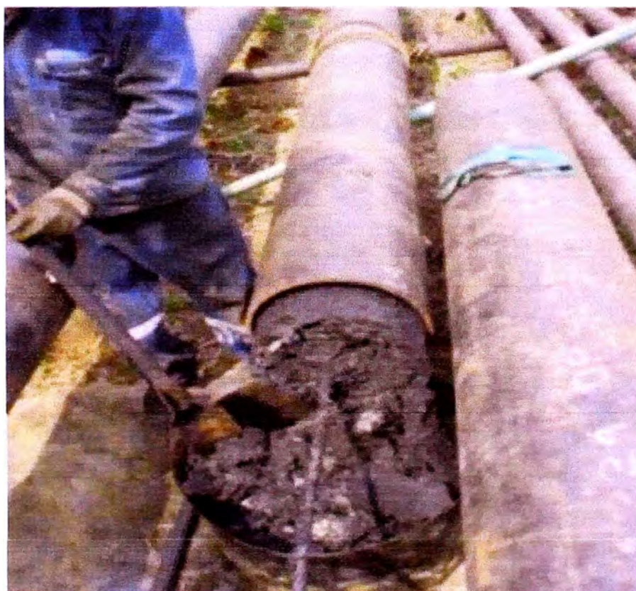
Fig. 3.4 Tubería obstruida Fuente: Foto de archivo
