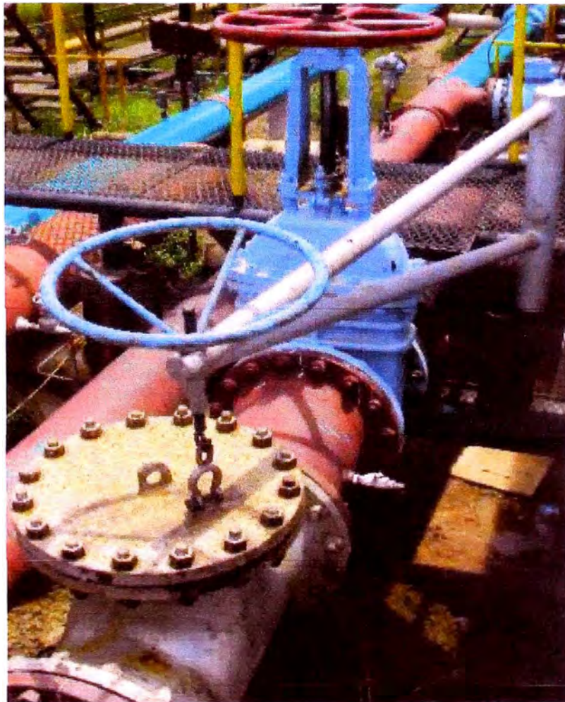
Fig. 4.6 Brazo giratorio para levantar la tapa de filtro Fuente: Fotos de archivo de JDL
