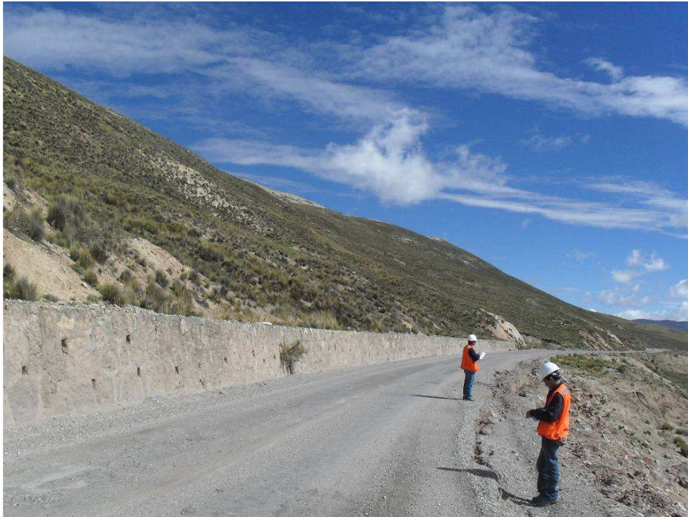
Vista panorámica de la vía. Muro construido para estabilizar el talud. Progresiva 208+500
