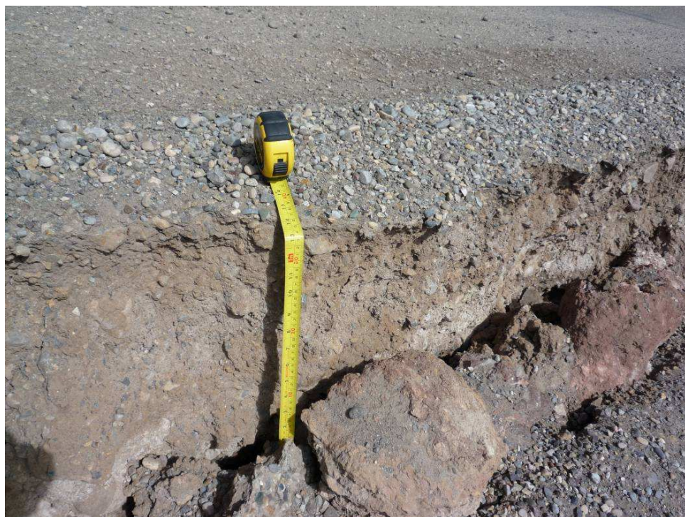
Hundimiento en el talud debido a la erosión causada por las aguas de escorrentía – Progresiva 208+700
